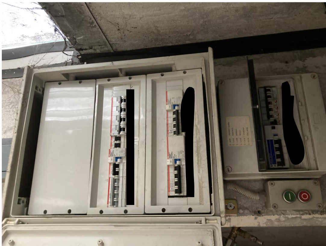
FOTO 13 –QUADRO ELETTRICO (LOTTO A).
