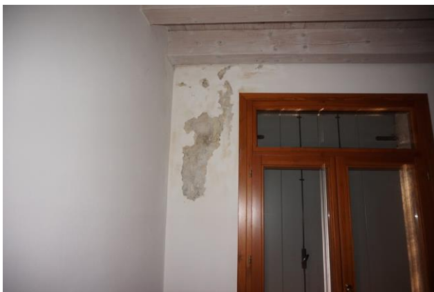
Piano primo – Particolare ammaloramento parete ovest camera
