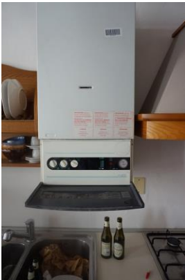
Piano primo – Caldaia inserita su zona cucina
