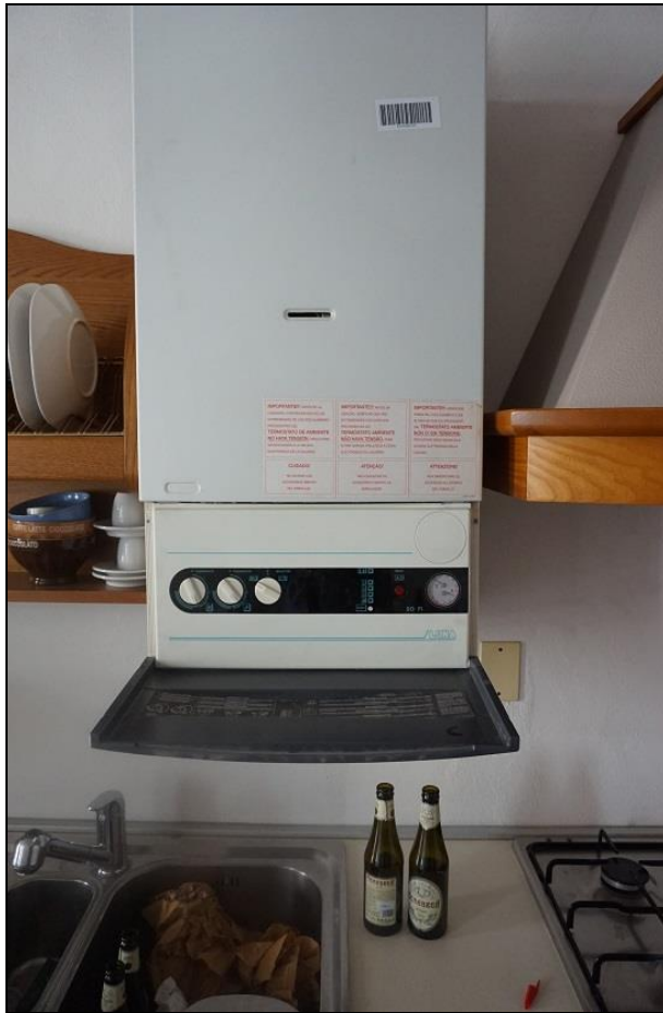
FOTO 15 – Piano primo – Caldaia inserita su zona cucina
