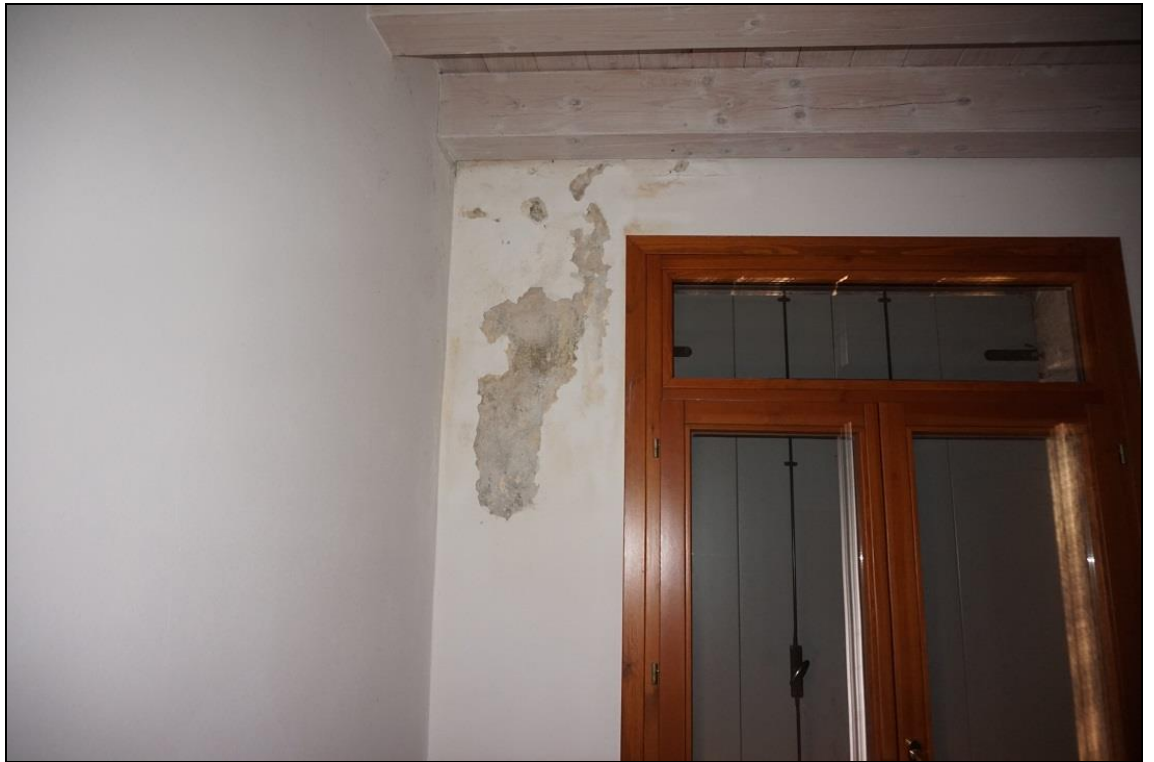
FOTO 21 – Piano primo – Particolare ammaloramento parete ovest camera
