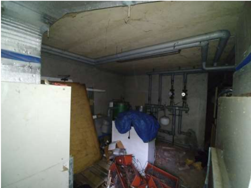
- FOTO 163 - Locale quadro elettrico e trattamento aria mapp.832 sub.49
