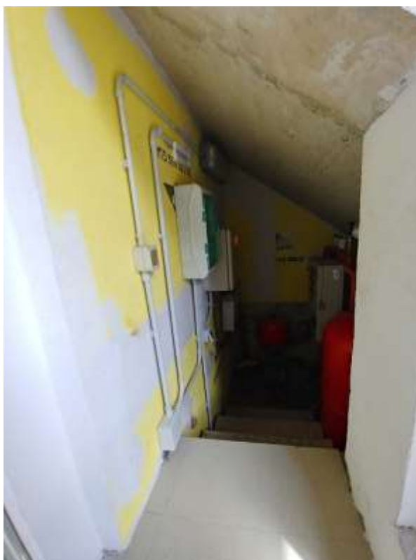
- FOTO 94 - Locale pompe antincendio sottoscala
