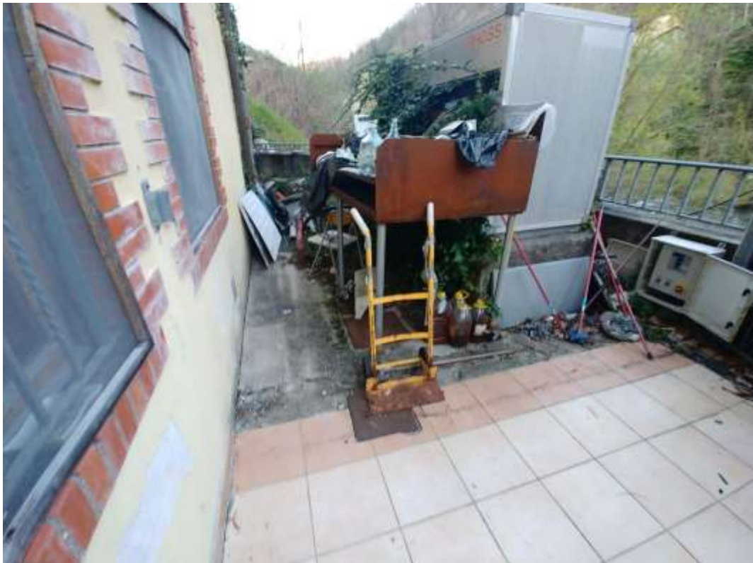
- FOTO 161 - Impianti su resede comune mapp.832 sub.52 lato Lima
