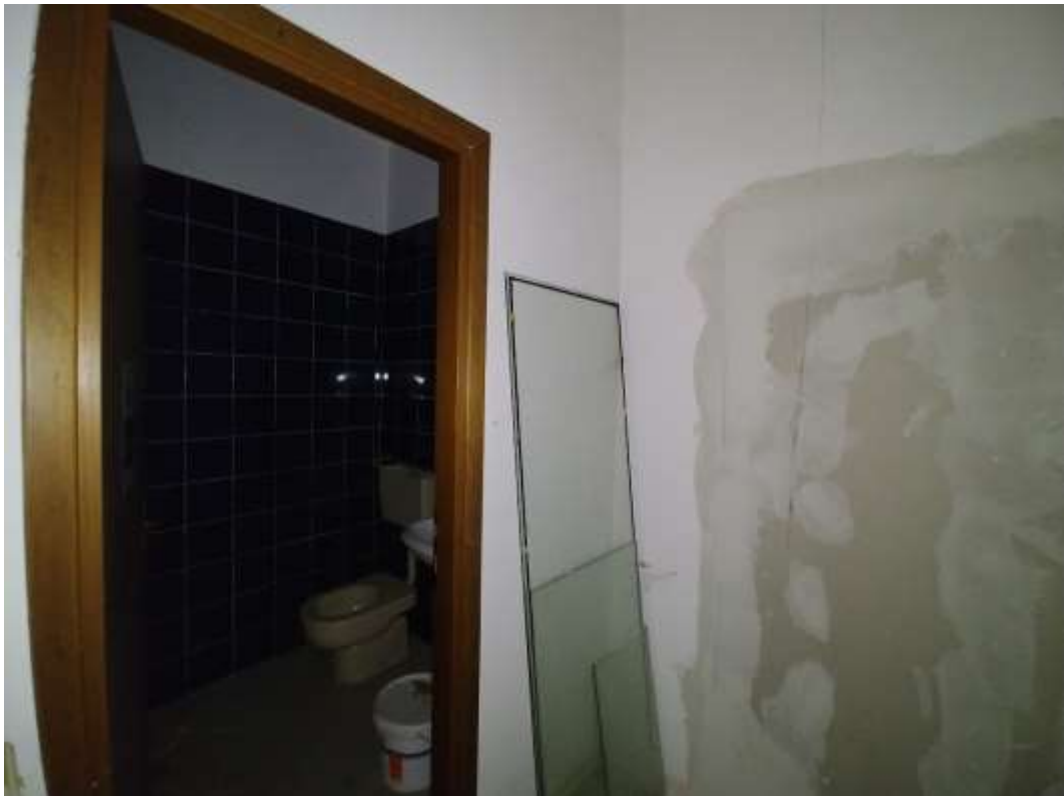
- FOTO 198 - Servizio igienico lotto 9 porzione "A"
