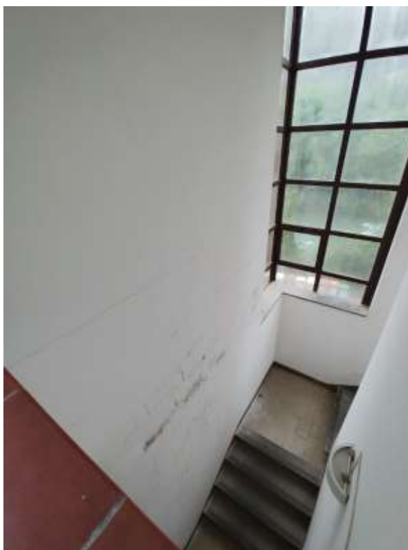
- FOTO 103 - Vano scale mapp.832 sub.36
