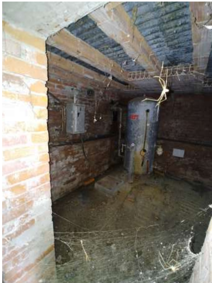
- FOTO 36 - Locale tecnico posto in prossimità della vasca antincendio a nord-ovest
