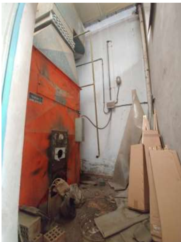
- FOTO 25 - Locale caldaia p.t. ricavato all'interno del locale magazzino cornici
