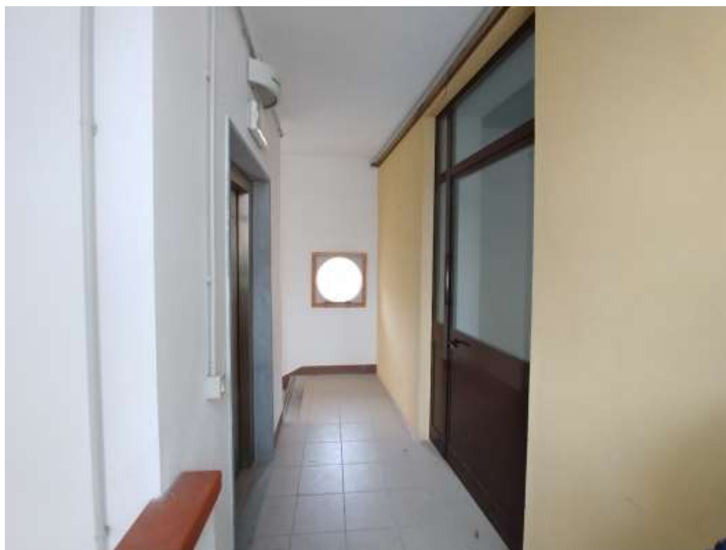
- FOTO 104 - Vano scale mapp.832 sub.36
