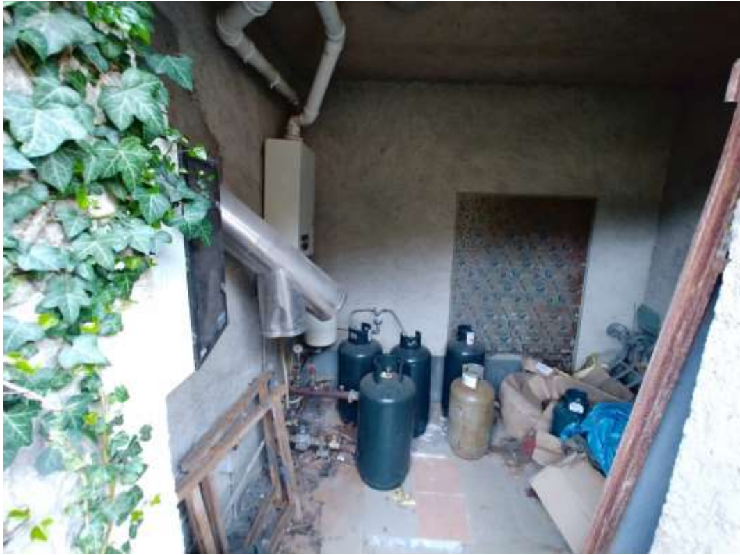
- FOTO 162 - Locale caldaia mapp.832 sub.49
