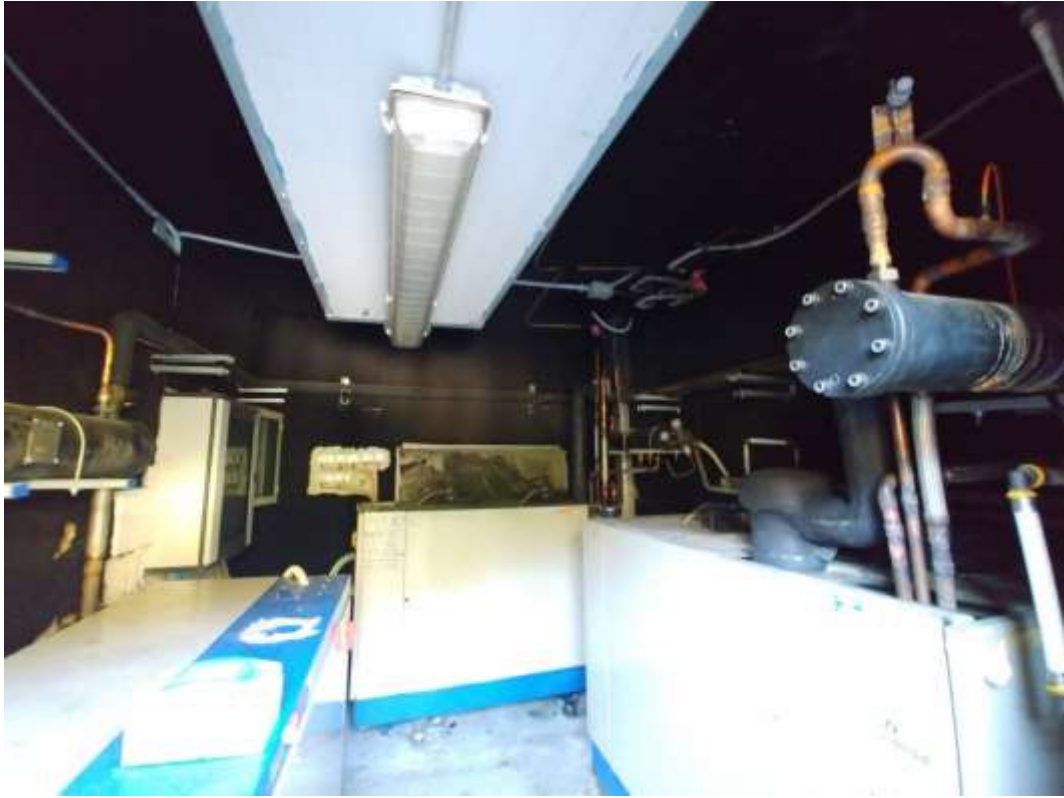
- FOTO 97 - Locale tecnico (motori banchi frigo) al p.t.
