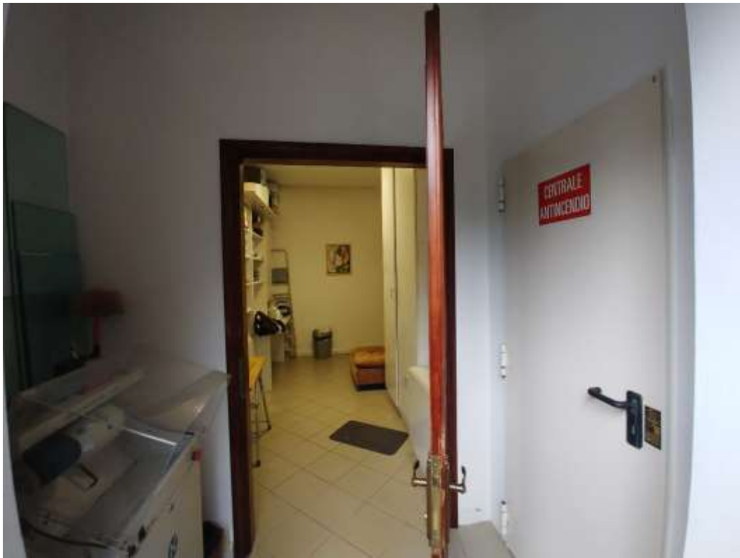
- FOTO 95 - Ingresso al p.t. che conduce sia al locale pompe antincendio sottoscala che al mapp.832 sub.46 (oggetto del lotto 7) a favore del quale dovrà essere costituita servitù di passaggio.
