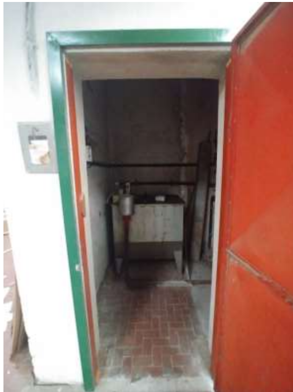
- FOTO 18 - Quadri elettrici p.t.
