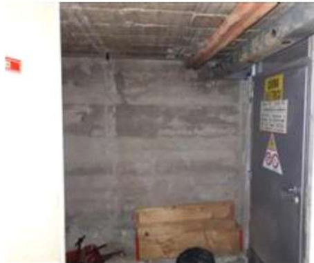
Cabina elettrica PS2
