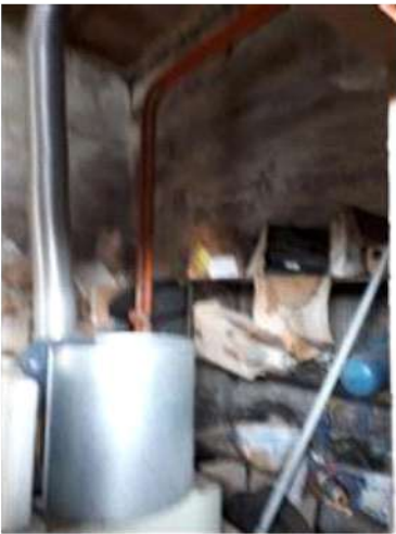
Centrale termica allo stato grezzo PS2
