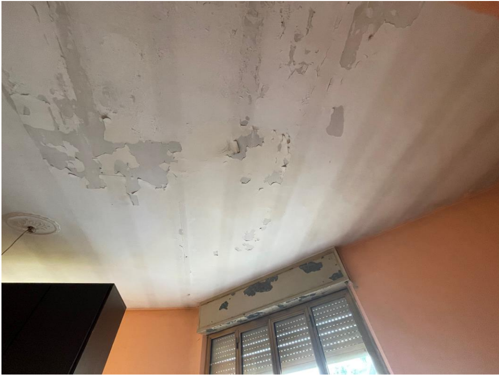
Particolare scrostamento pittura soffitti
