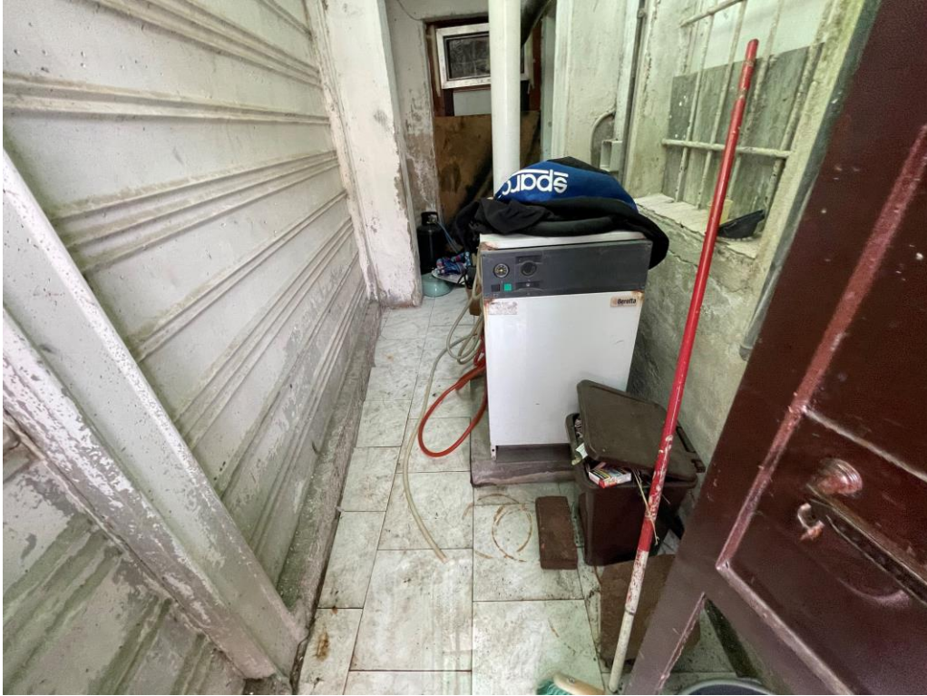
Caldaia non funzionante
