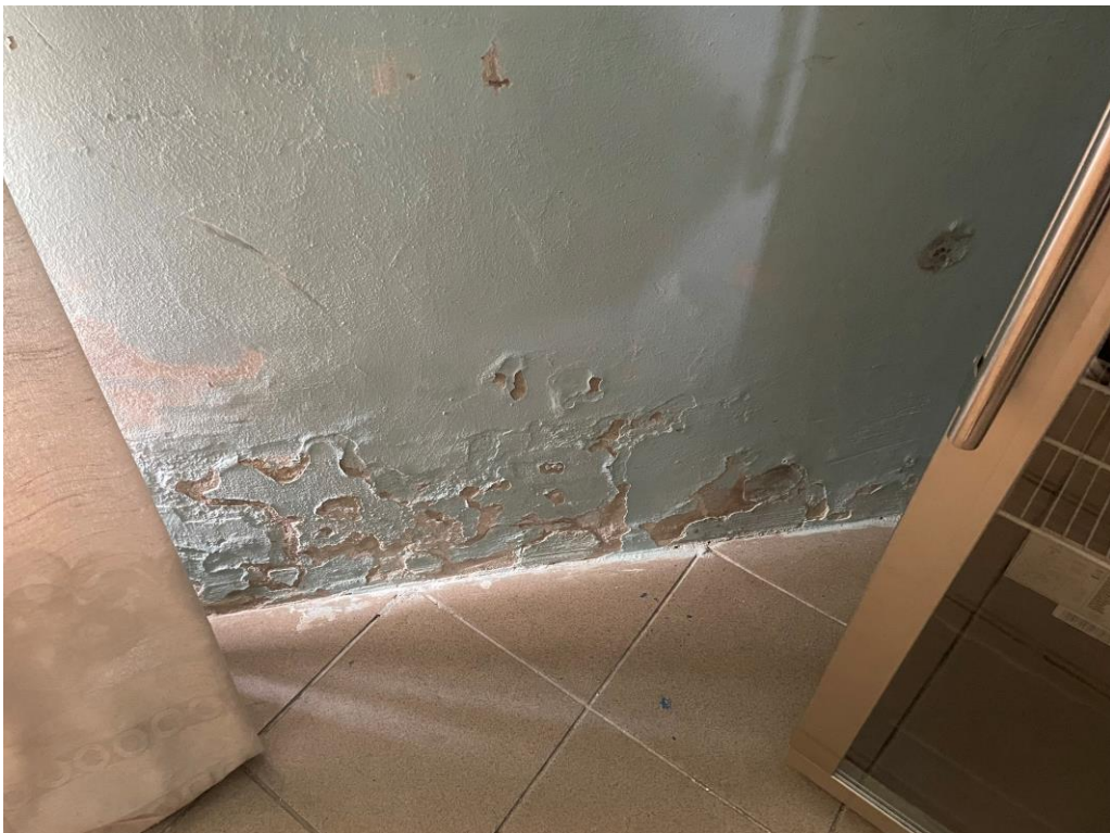
Particolare umidità di risalita
