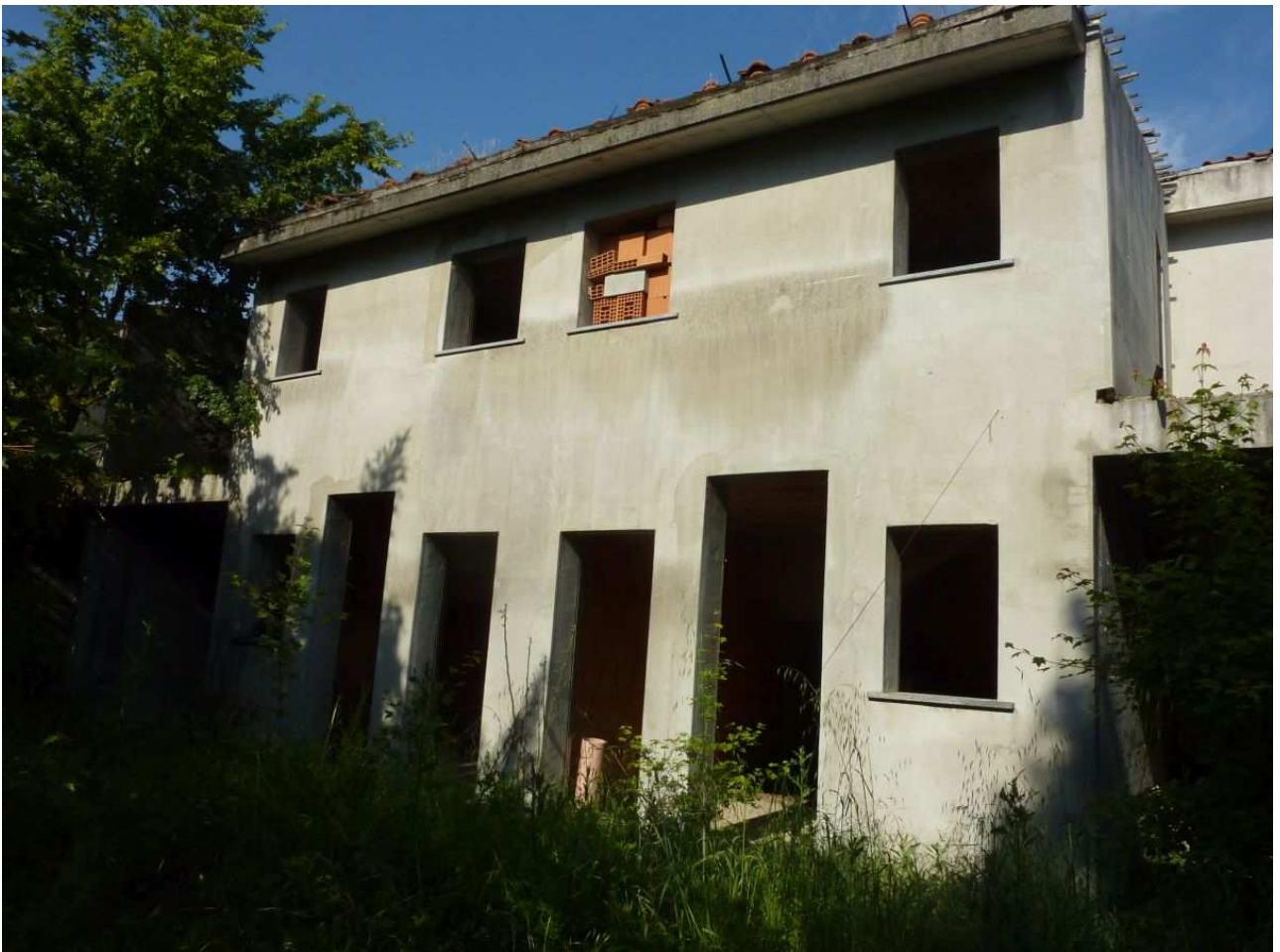
5. Fronte Ovest con gli accessi alle unità centrali delle villette a schiera con relative autorimesse
