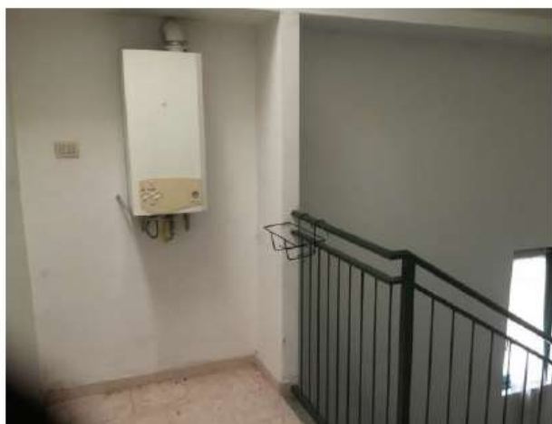
Foto 15 – Interno capannone – Caldaia al P1
