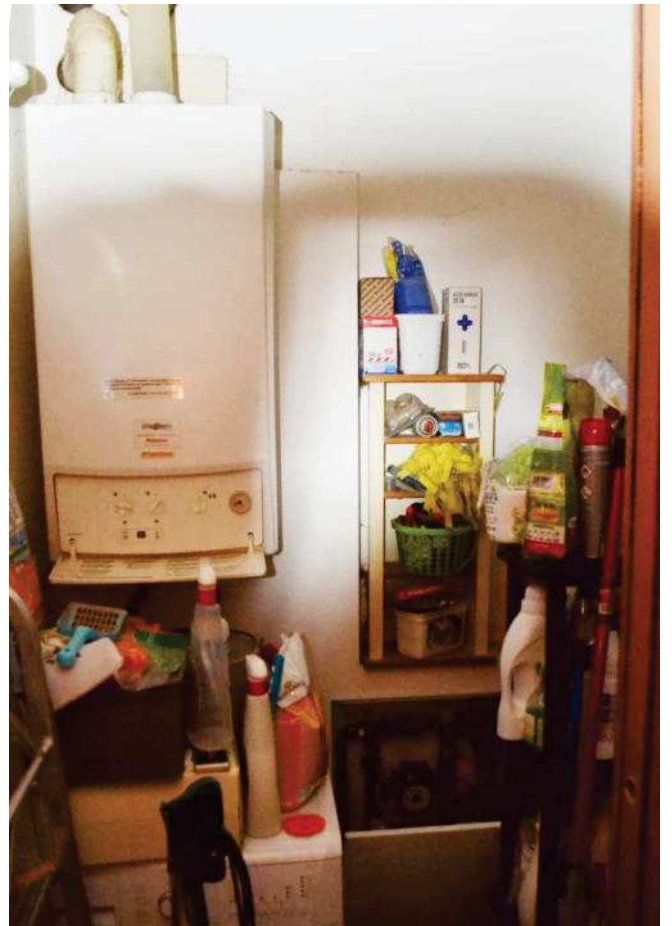
foto 12 - Ripostiglio con la caldaia autonoma
