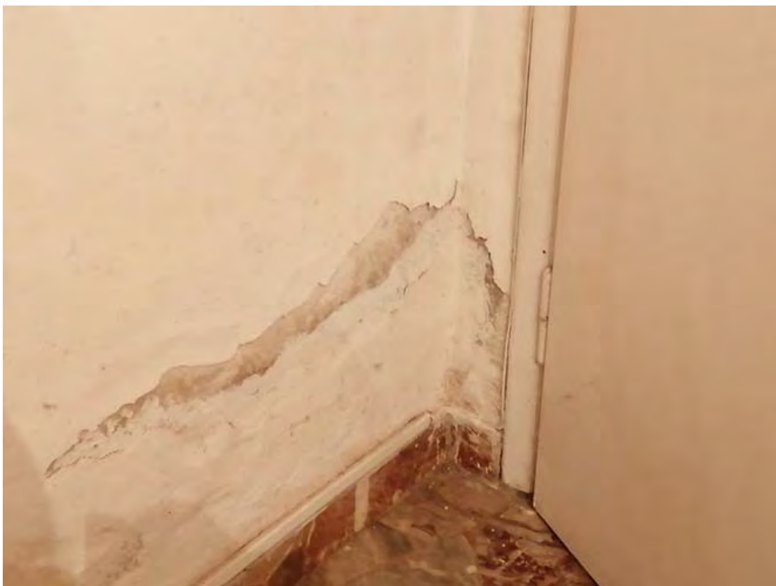
Foto 17 – Altro particolare di fenomeno da condensazione
