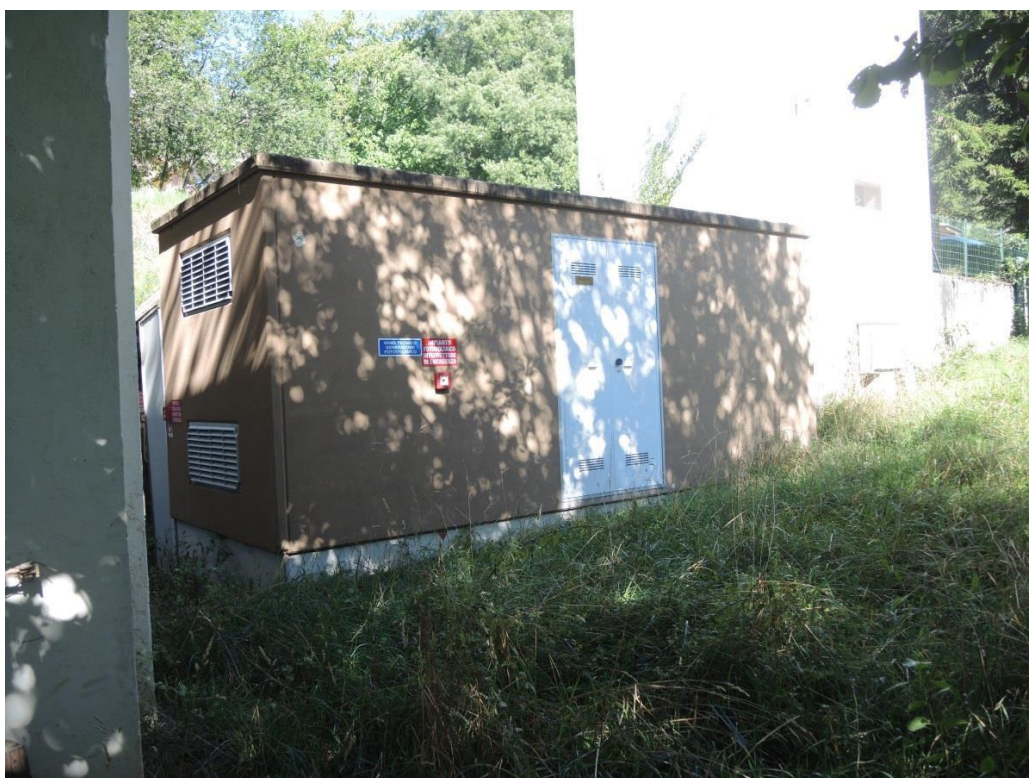
Cortile cabina elettrica per impianto fotovoltaico
