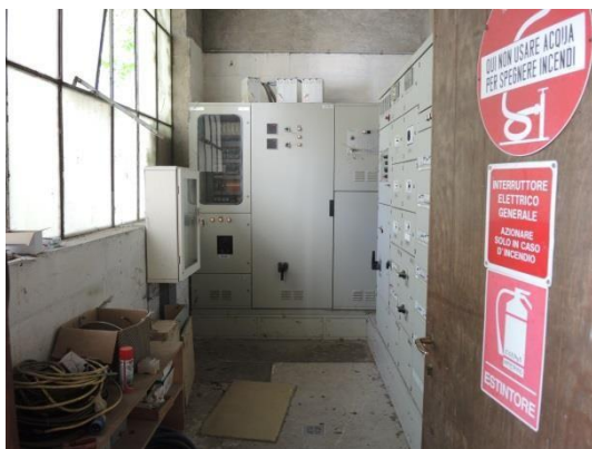
Quadro elettrico piano terra
