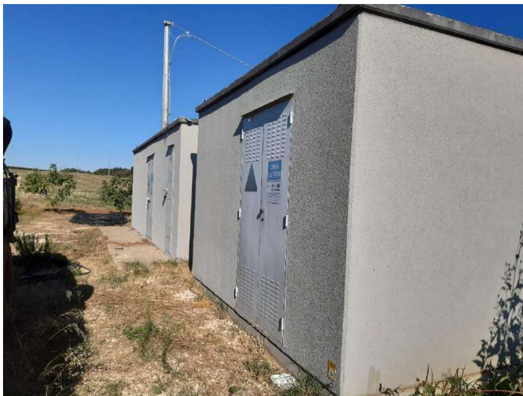
Comune di Montescaglioso Cabine di Servizio
