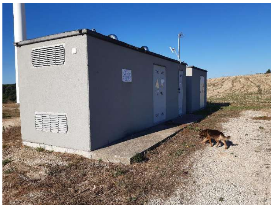
Comune di Montescaglioso Cabine di Servizio
