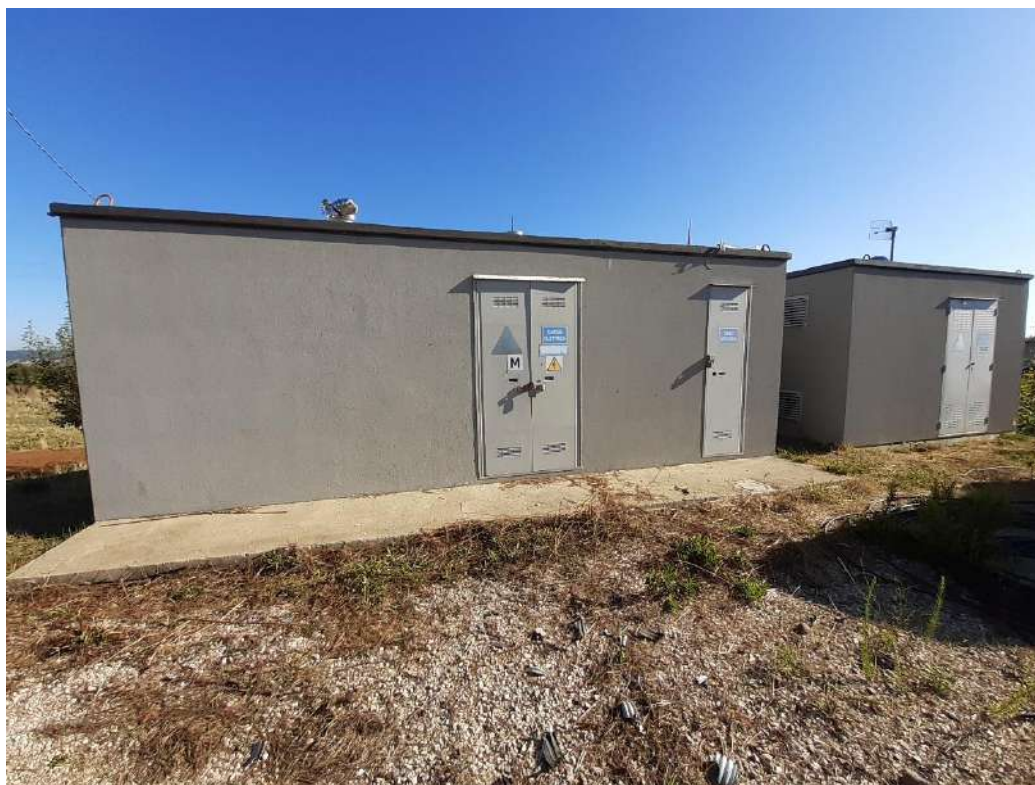
Comune di Montescaglioso Cabine di Servizio
