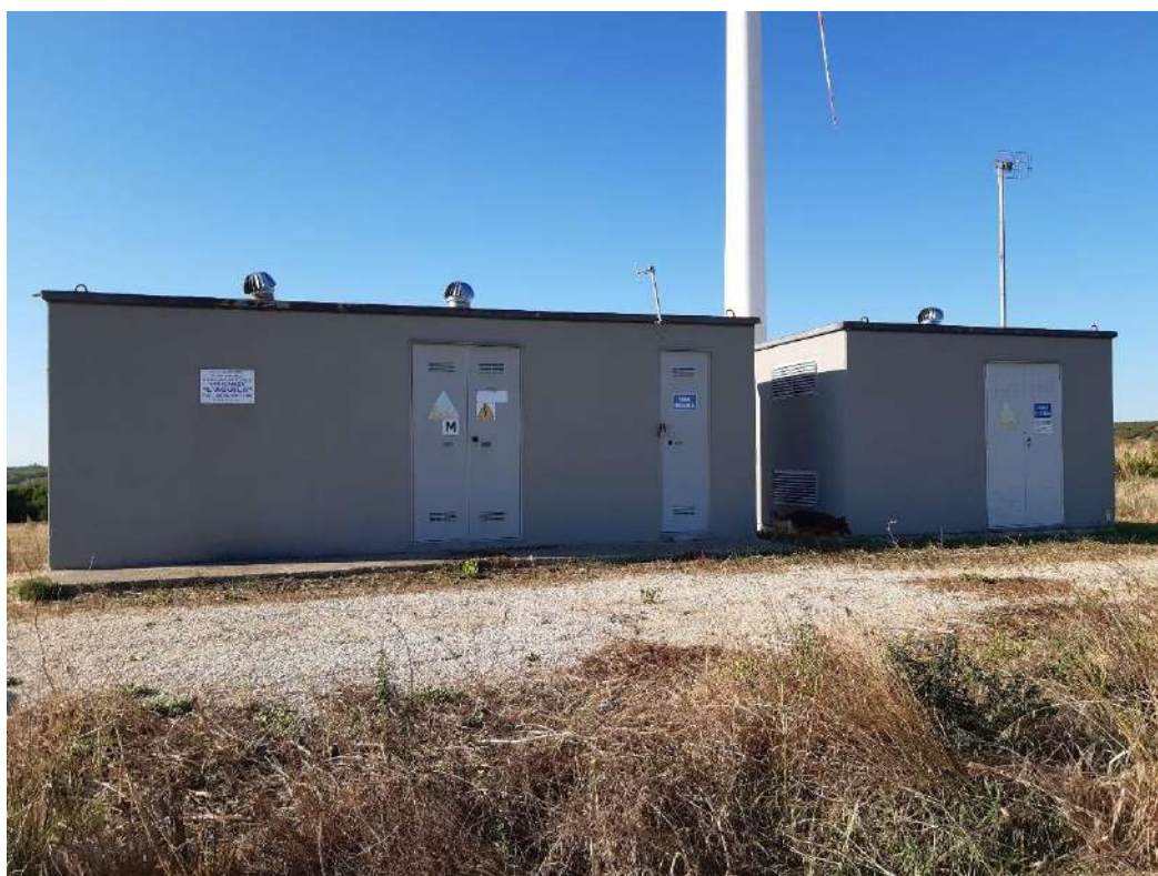
Comune di Montescaglioso Cabine di Servizio
