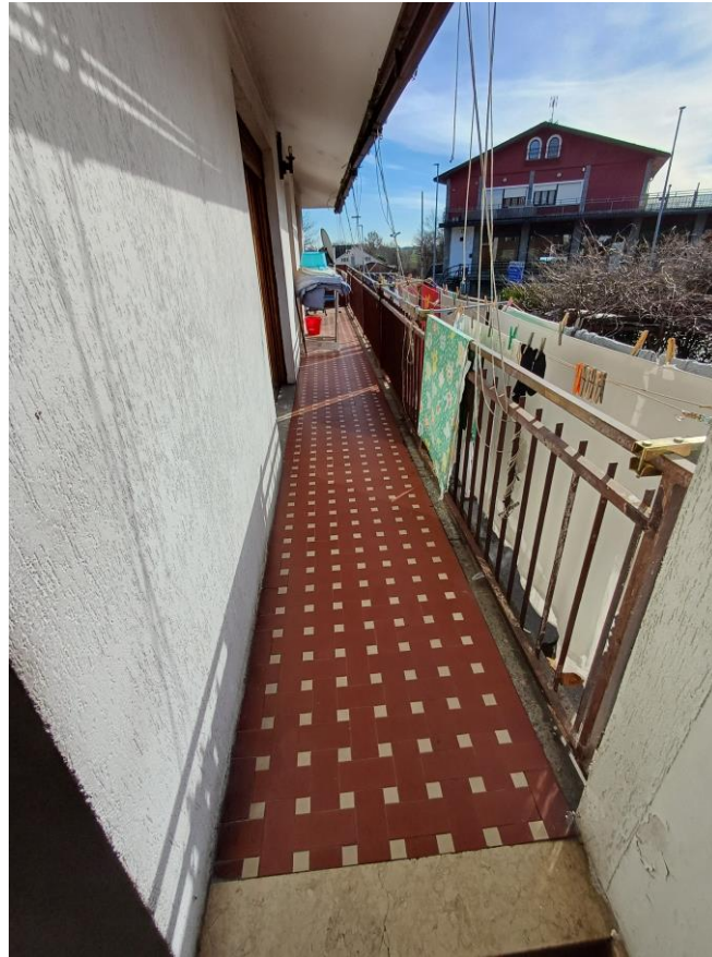
Foto 14 – Balcone primo piano
