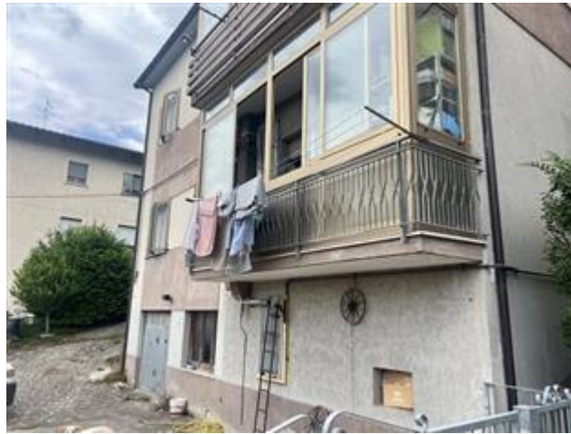
Abuso con chiusura balcone
