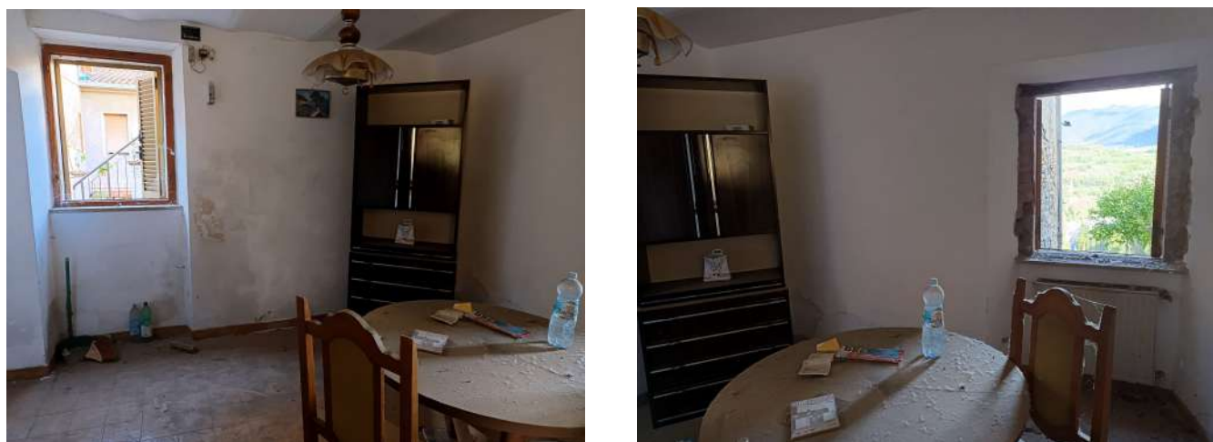
Foto n. 18-20: vista del soggiorno/pranzo. Dettaglio finestre con infissi mancanti
