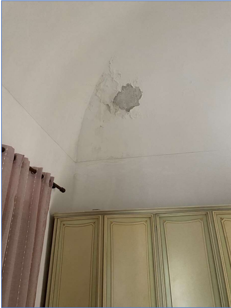
FOTO 27. PARTICOLARE INFILTRAZIONE CAMERA [#10].
