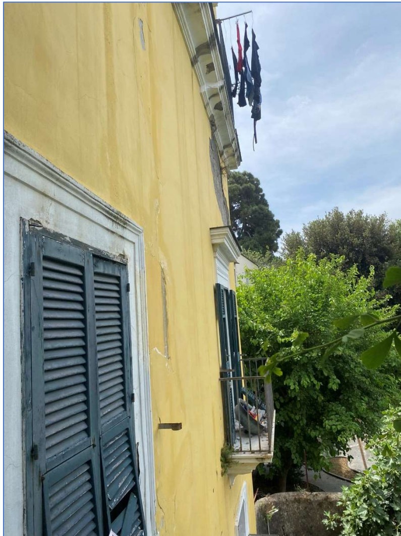
FOTO 36. BALCONI SU PROSPETTO OVEST.
