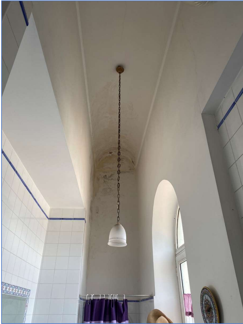
FOTO 29. PARTICOLARE INFILTRAZIONE BAGNO [#11].
