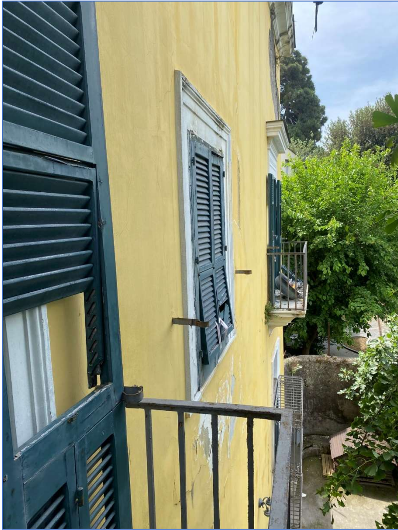
FOTO 35. BALCONI SU PROSPETTO OVEST.
