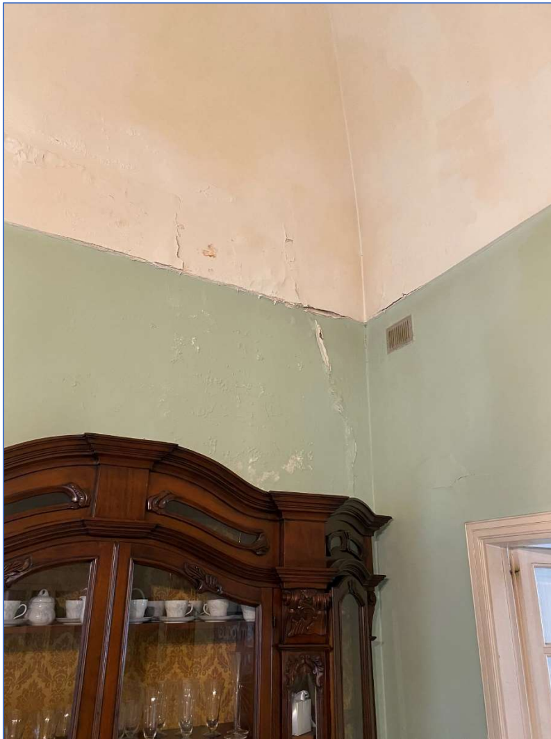
FOTO 13. PARTICOLARE INFILTRAZIONI SALONE [#2].
