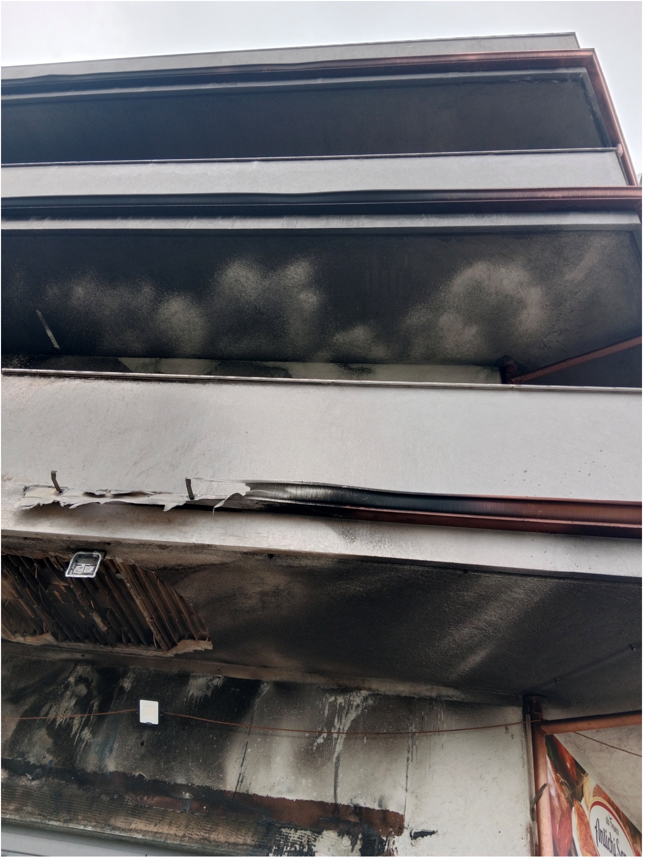
Solaio interessato da eventi di crollo
