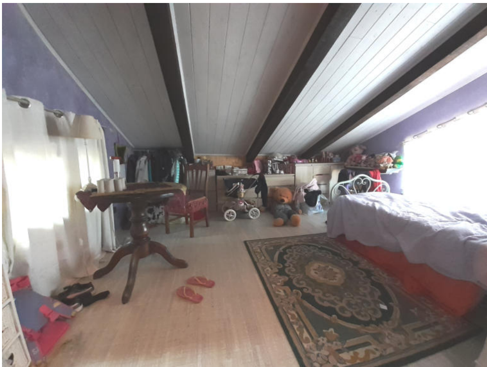
FOTO 24 – CAMERA ABUSIVA AL P.1°
