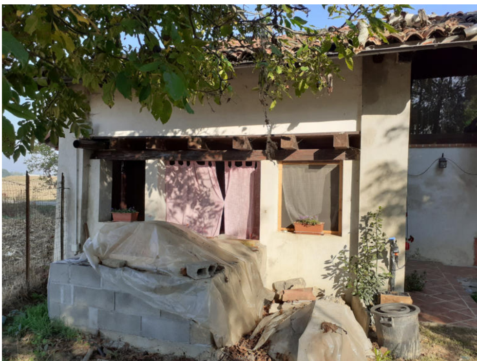
FOTO 22 – CHIUSURA ABUSIVA DEL PENDIZZO
