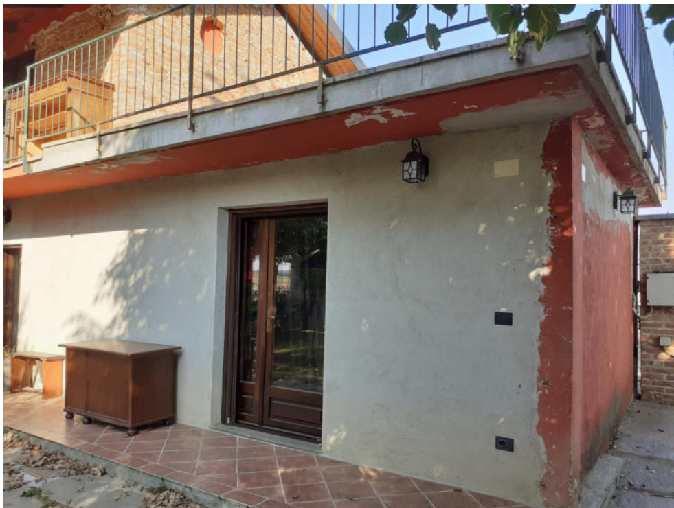
FOTO 18 – PORTAFINESTRA DIFFORME MAGAZZINO VISTA ESTERNA
