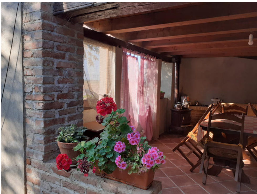
FOTO 21 - CHIUSURA ABUSIVA DEL PENDIZZO
