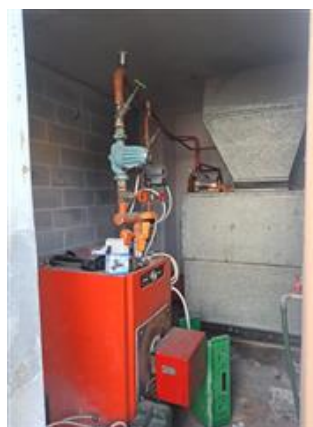
Locale caldaia e contatori acqua in vano condominiale
