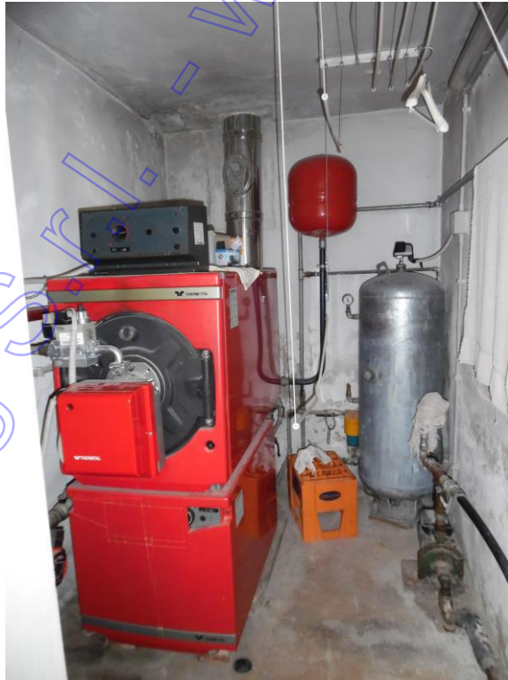
Centrale Termica p.T (sub. 5)
