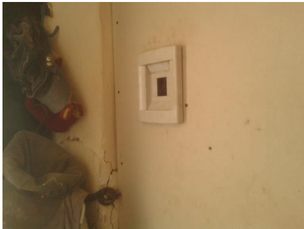
Quadro elettrico sezionamento
