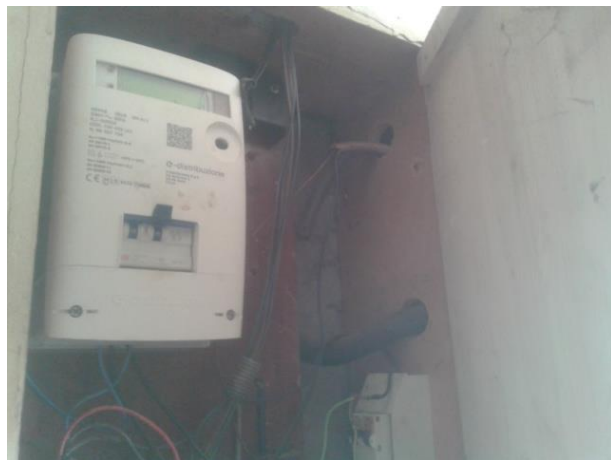
Contatore energia elettrica in nicchia ingresso
