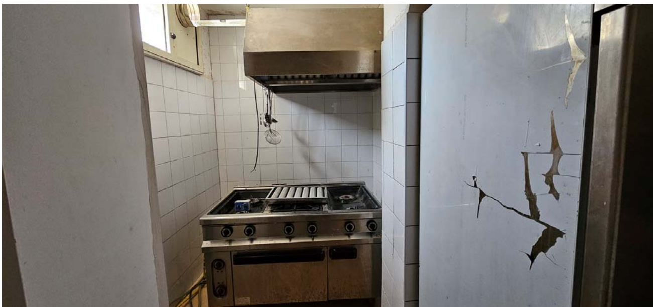
Vano difforme: cucina piano primo
