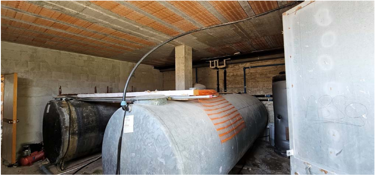
Vano difforme: deposito per riserve idriche, piano terra
