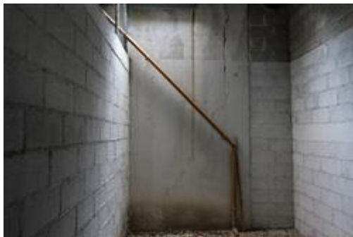
Parete a Nord-Est parte inferiore
