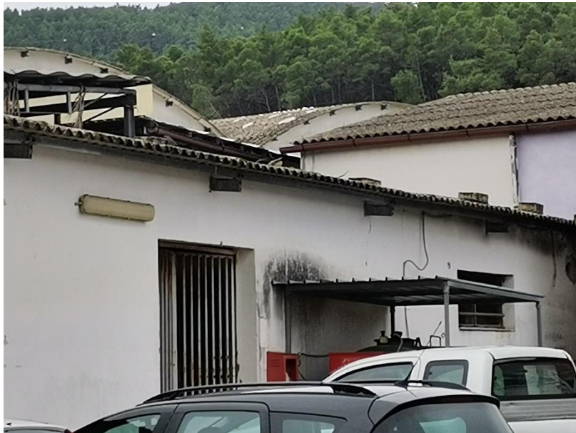
Le coperture in cemento-amianto sulle p.lle 154 e 144
