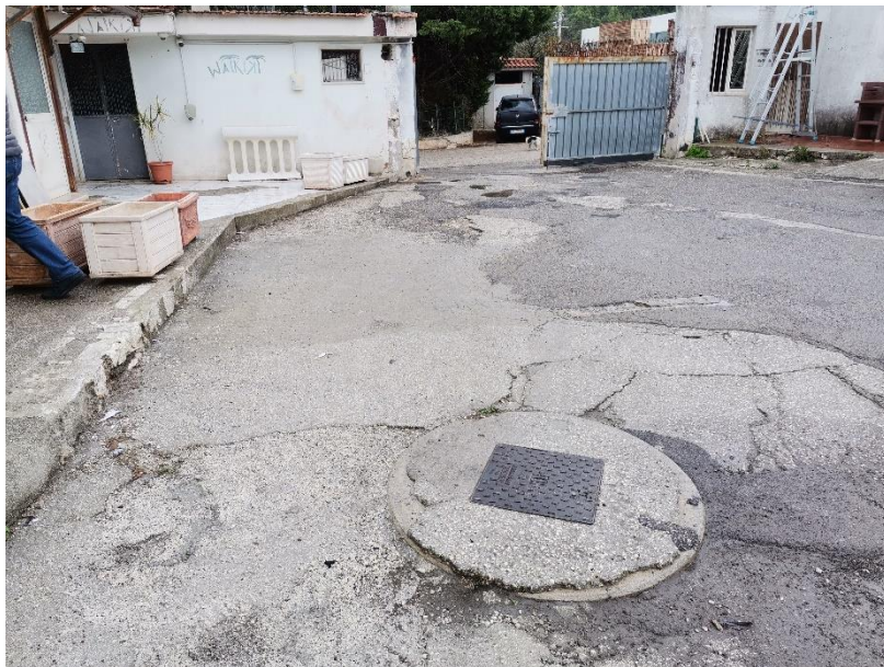
Il pozzo imhoff nella p.lla 131
