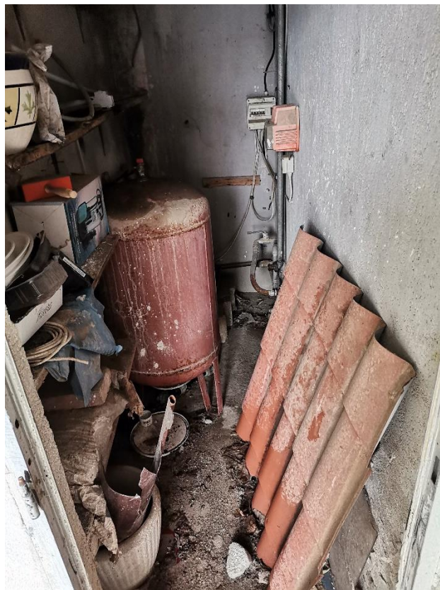
Il locale pompe per la distribuzione dell'acqua
