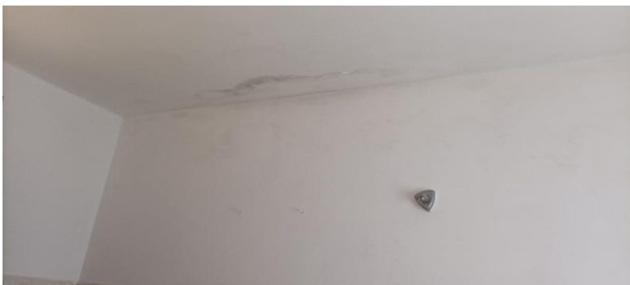
PROBEMI DI MUFFE/INFILTRAZIONI
