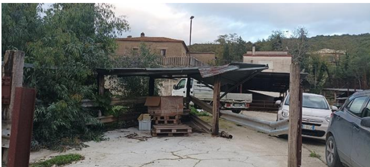
MANUFATTI IN FASE DI REALIZZAZIONE E DI ABBANDONO
