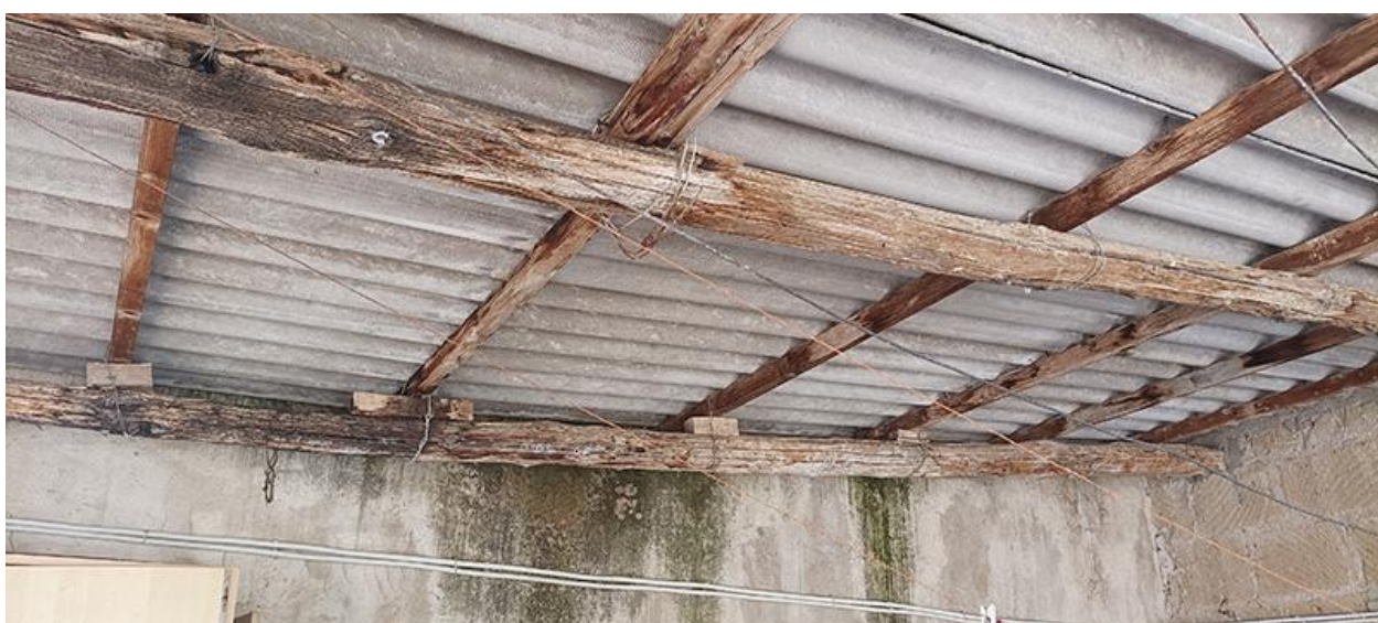
COPERTURA DEL TERRAZZO IN AMIANTO
