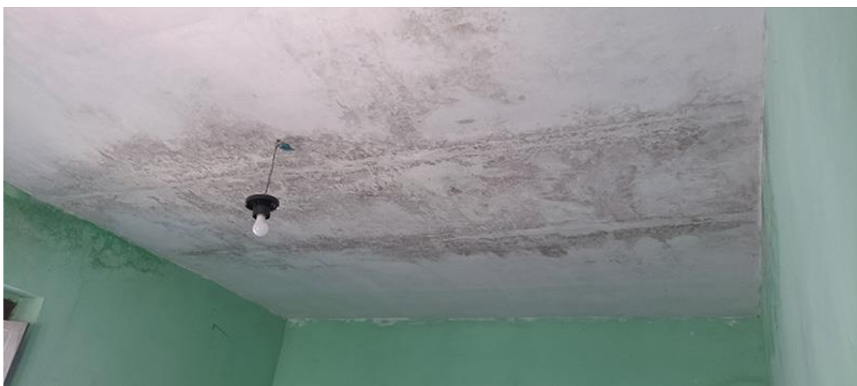
PROBEMI DI MUFFE/INFILTRAZIONI
