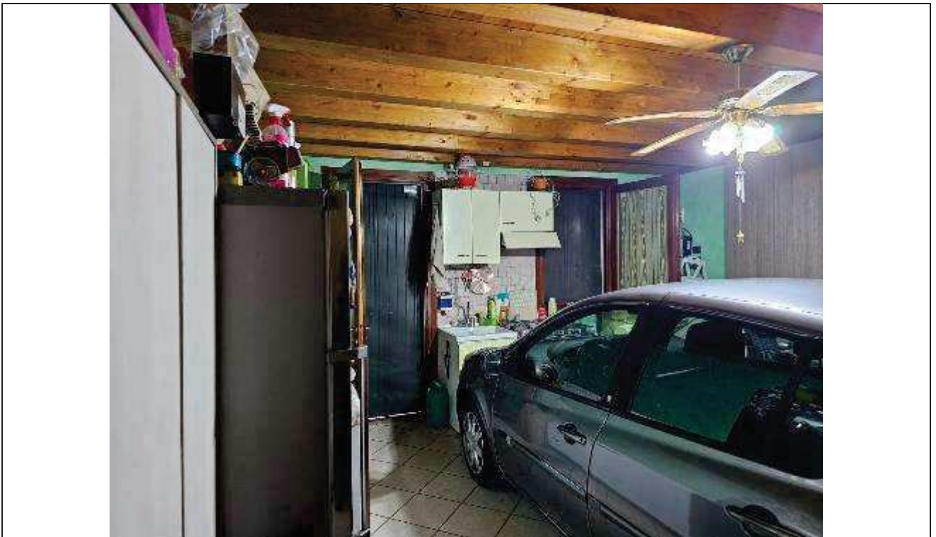
50 Vista interna dell'autorimessa – in fondo si nota la porta finestra in luogo dell'autorizzata finestra;
