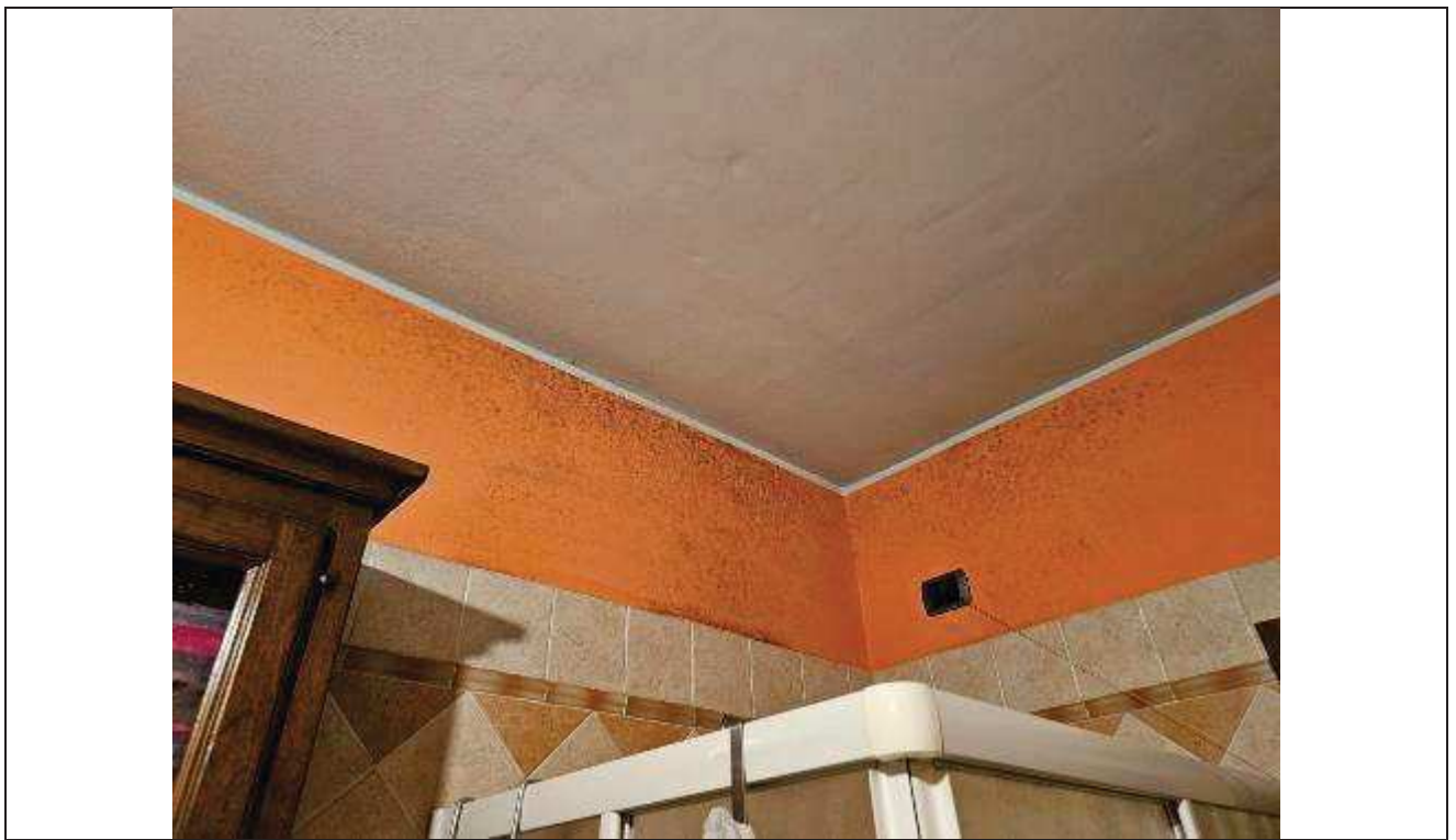
43 Particolare del soffitto e pareti della lavanderia, con presenza di muffe;
