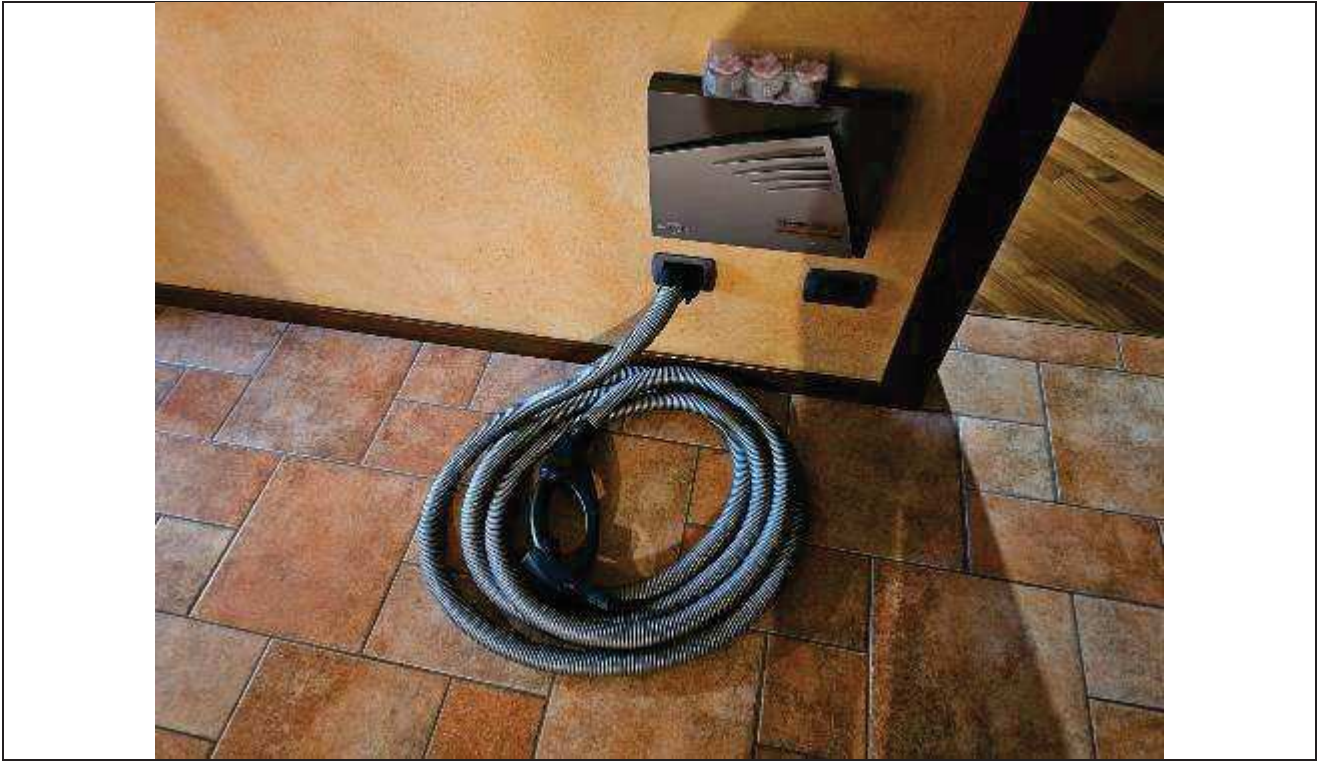
47 Vista dell'aspirazione centralizzata;
