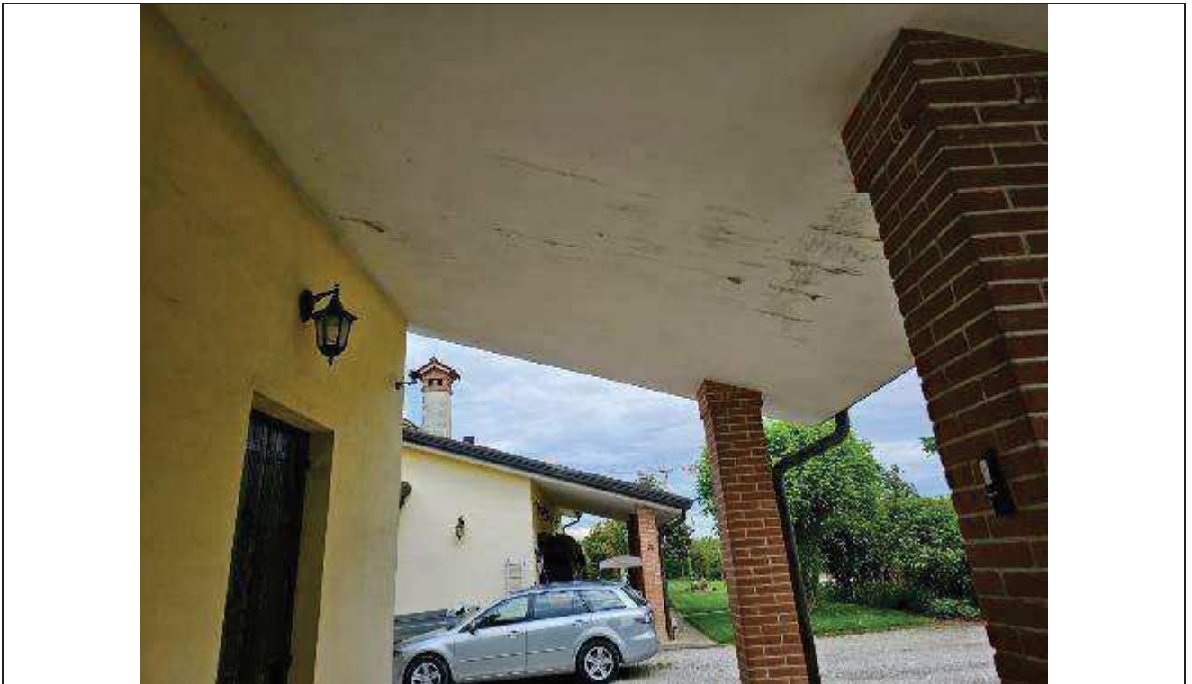
58 Particolare del soffitto del porticato con evidenti segni di distacco della tinteggiatura;
