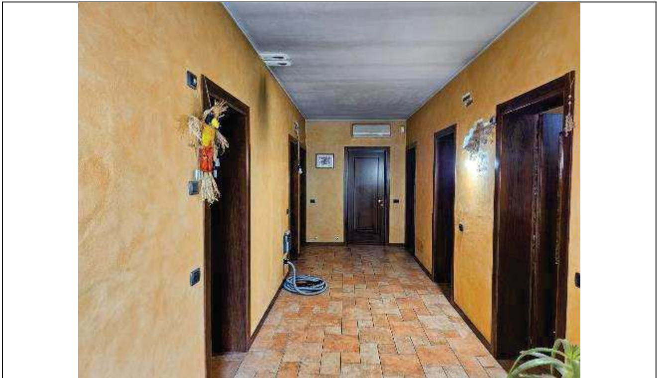
25 Vista del corridoio interno all'abitazione che distribuisce i vani, con presenza di macchie sul soffitto;
