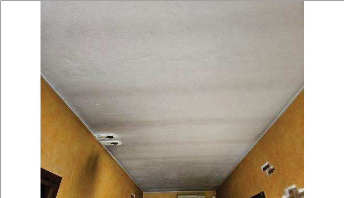
48 Particolare del soffitto del corridoio, con evidente presenza di muffe ed umidità;
