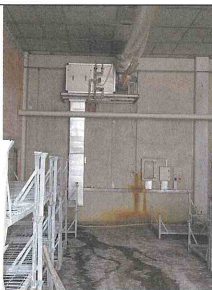
Foto n°155: Particolare impianto di aerazione
