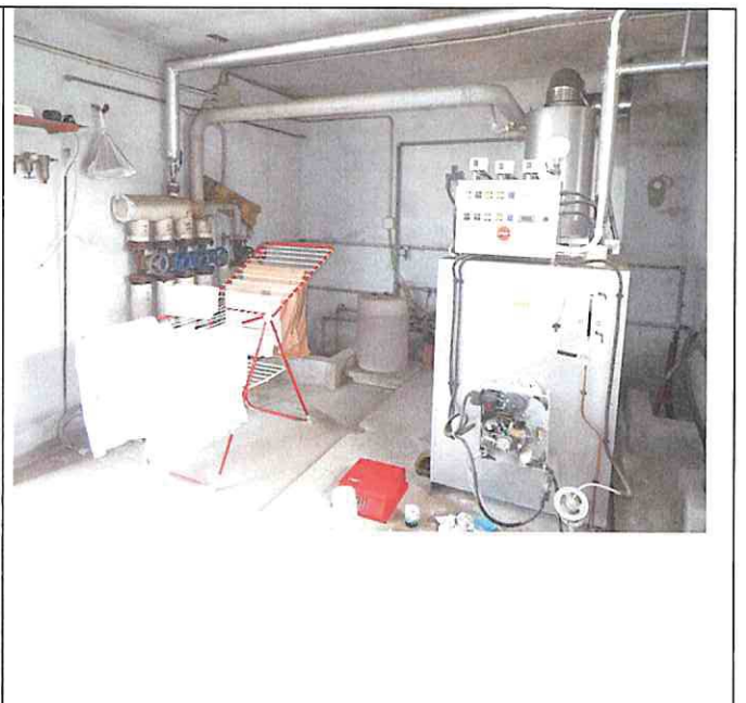
Foto n°92: Interno altro locale C.T.
