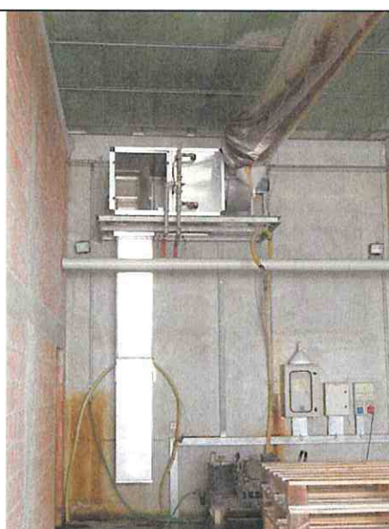
Foto n°151: Particolare impianto di aerazione
