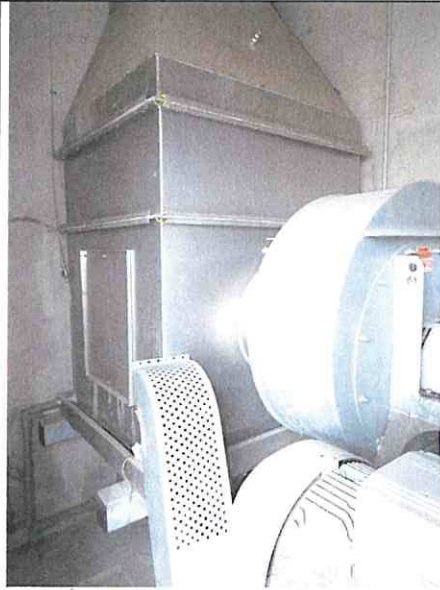
Foto n°99: Interno locale ventilatore
