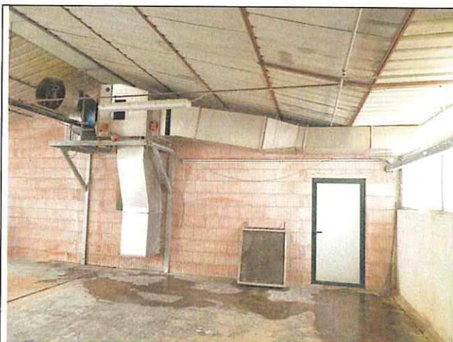
Foto n°56: Particolare impianto di trattamento aria
