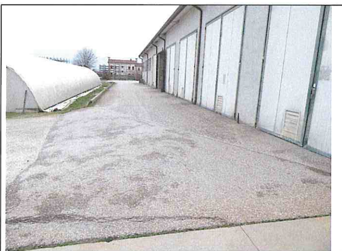
Foto n°160: Pavimentazione esterna est
