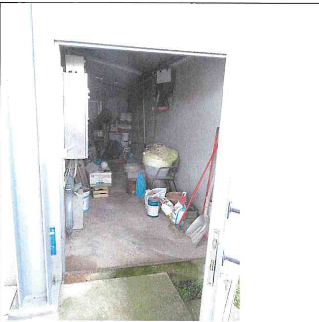
Foto n°95: Locale tecnico abusivo
