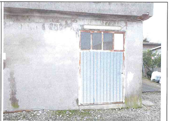
Foto n°90: Ingresso altro locale C.T.
