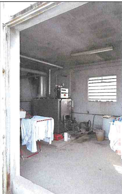
Foto n°91: Interno altro locale C.T.
