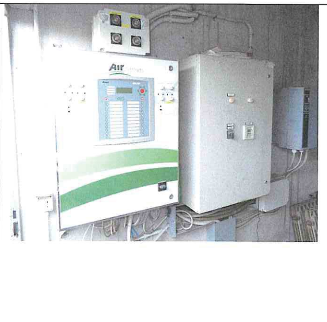
Foto n°96: Interno locale tecnico
