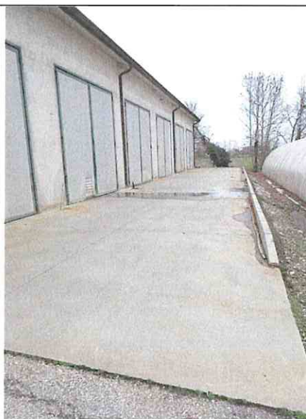
Foto n°159: Pavimentazione esterna est
