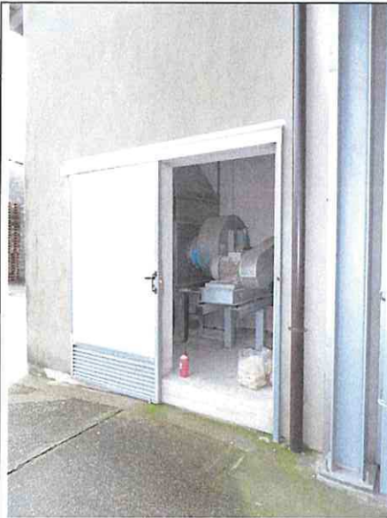
Foto n°101: Locale ventilatore ad est
