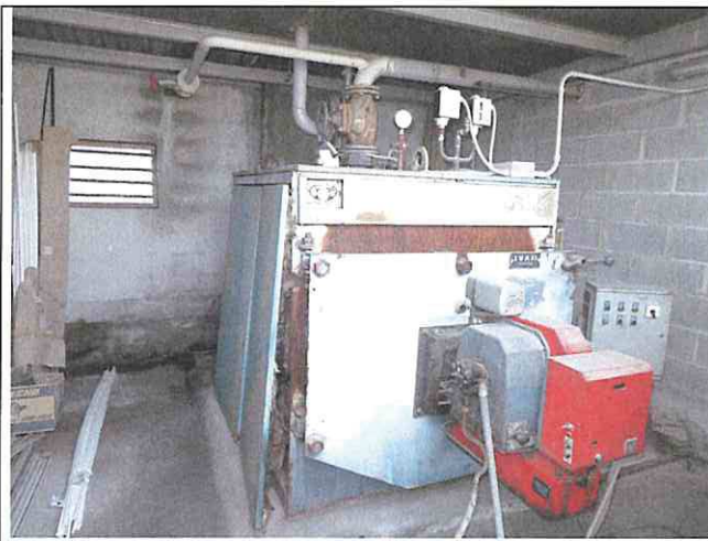
Foto n°89: Interno locale C.T.
