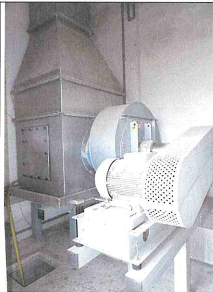
Foto n°102: Interno locale ventilatore
