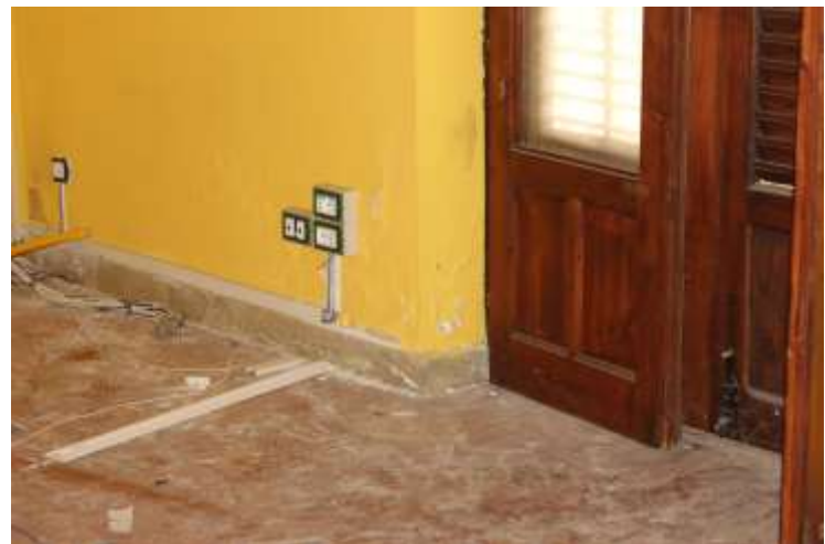
Particolare impianto elettrico Vano (2)
