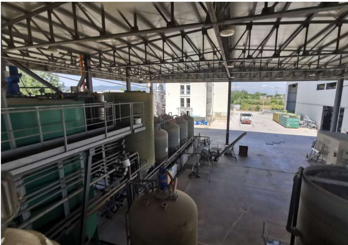
Foto n. 52 _ Sopralluogo 17/06/2020 Capannone CP1: dalla passerella sopraelevata vista sull'impianto
