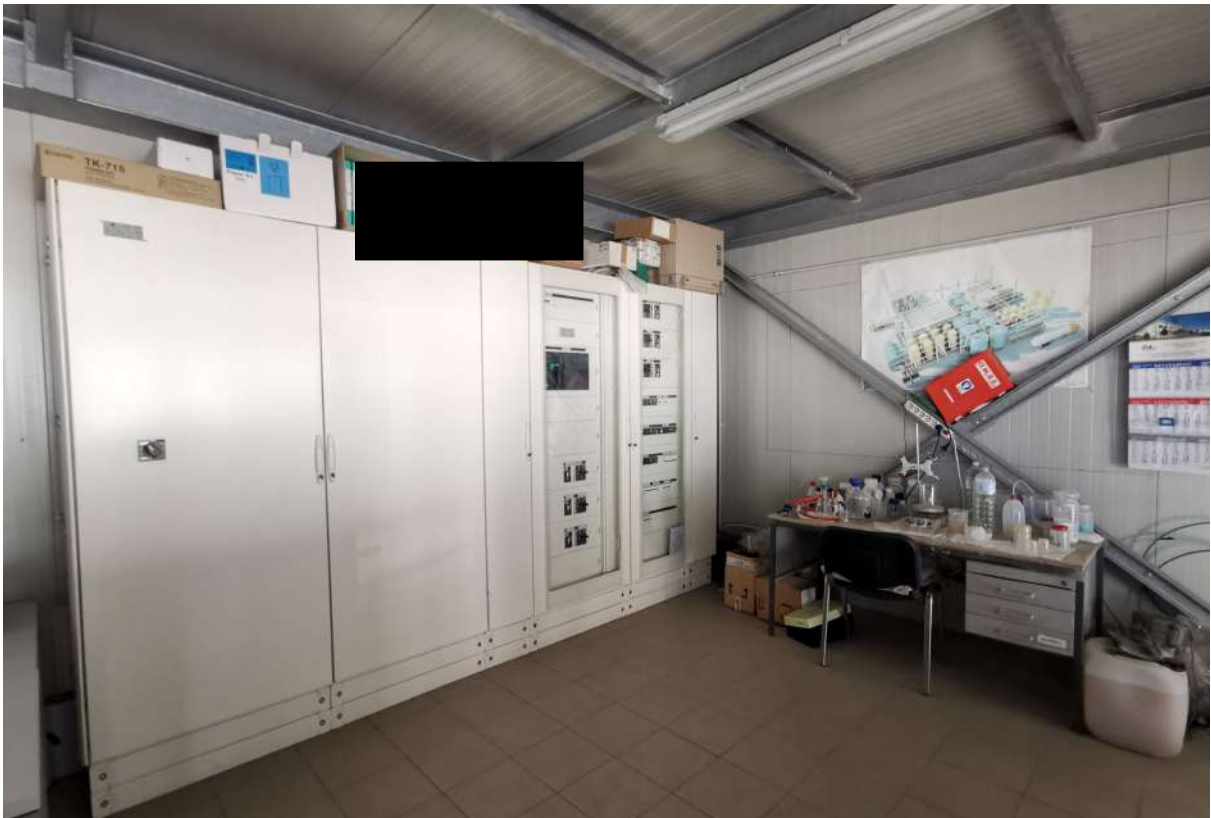
Foto n. 55 _ Sopralluogo 17/06/2020 Capannone CP1: dalla sala controllo, locale al piano secondo con quadri elettrici
