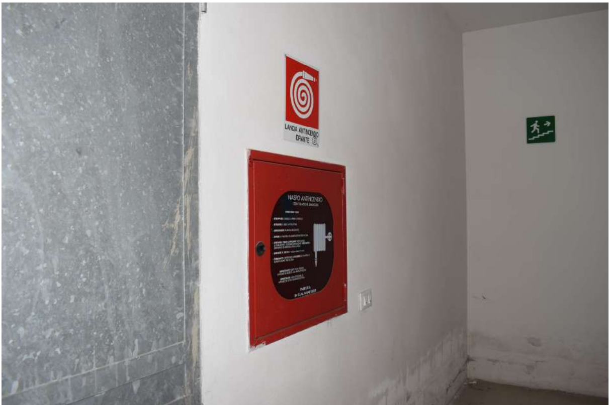
Foto n. 12 _ Sopralluogo 17/06/2020 Palazzina uffici: piano seminterrato, vano scala con lancia antincendio
