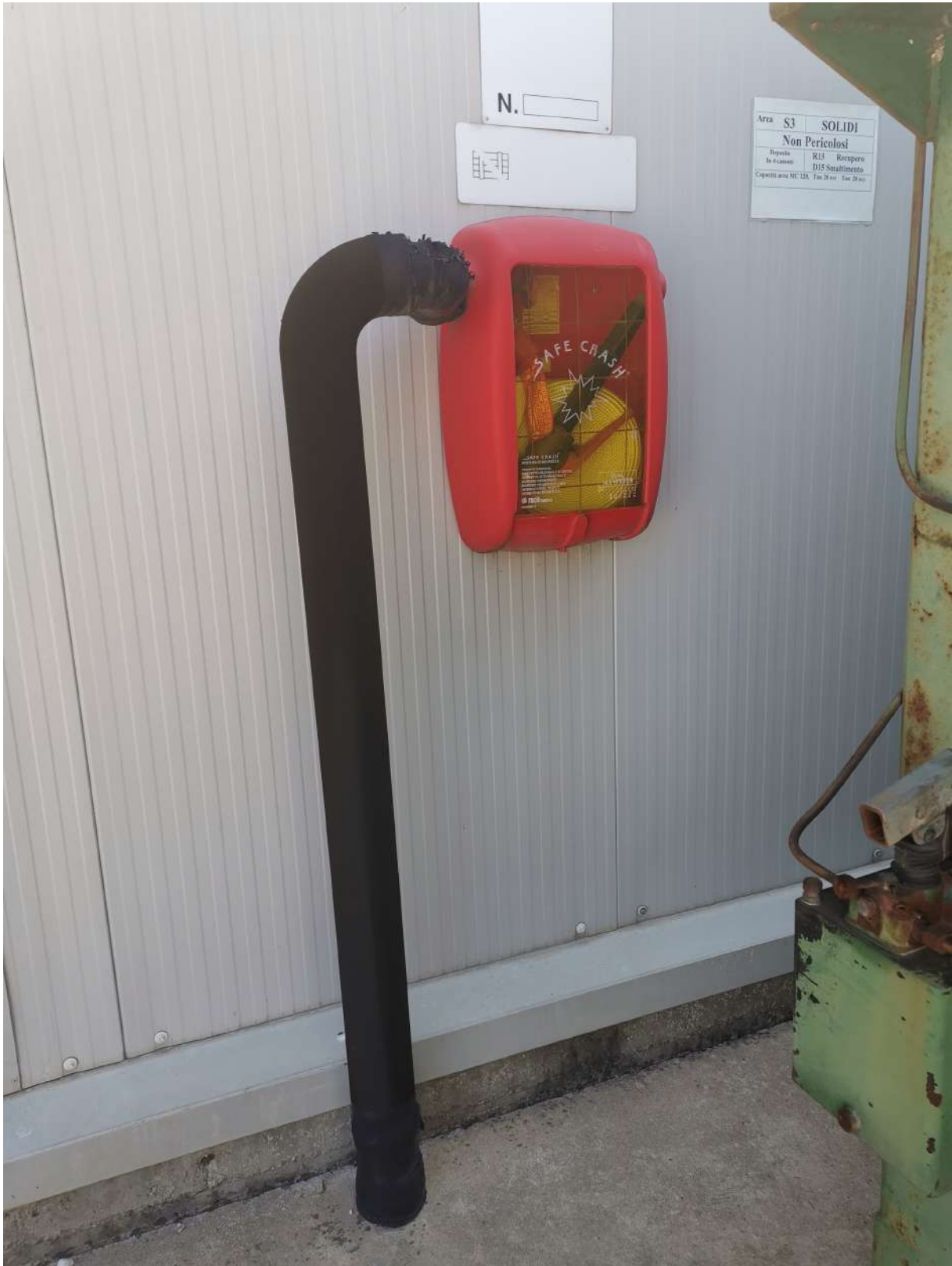
Foto n. 74 _ Sopralluogo 17/06/2020 Impianto antincendio, idranti a muro collegati a rete idrica antincendio
