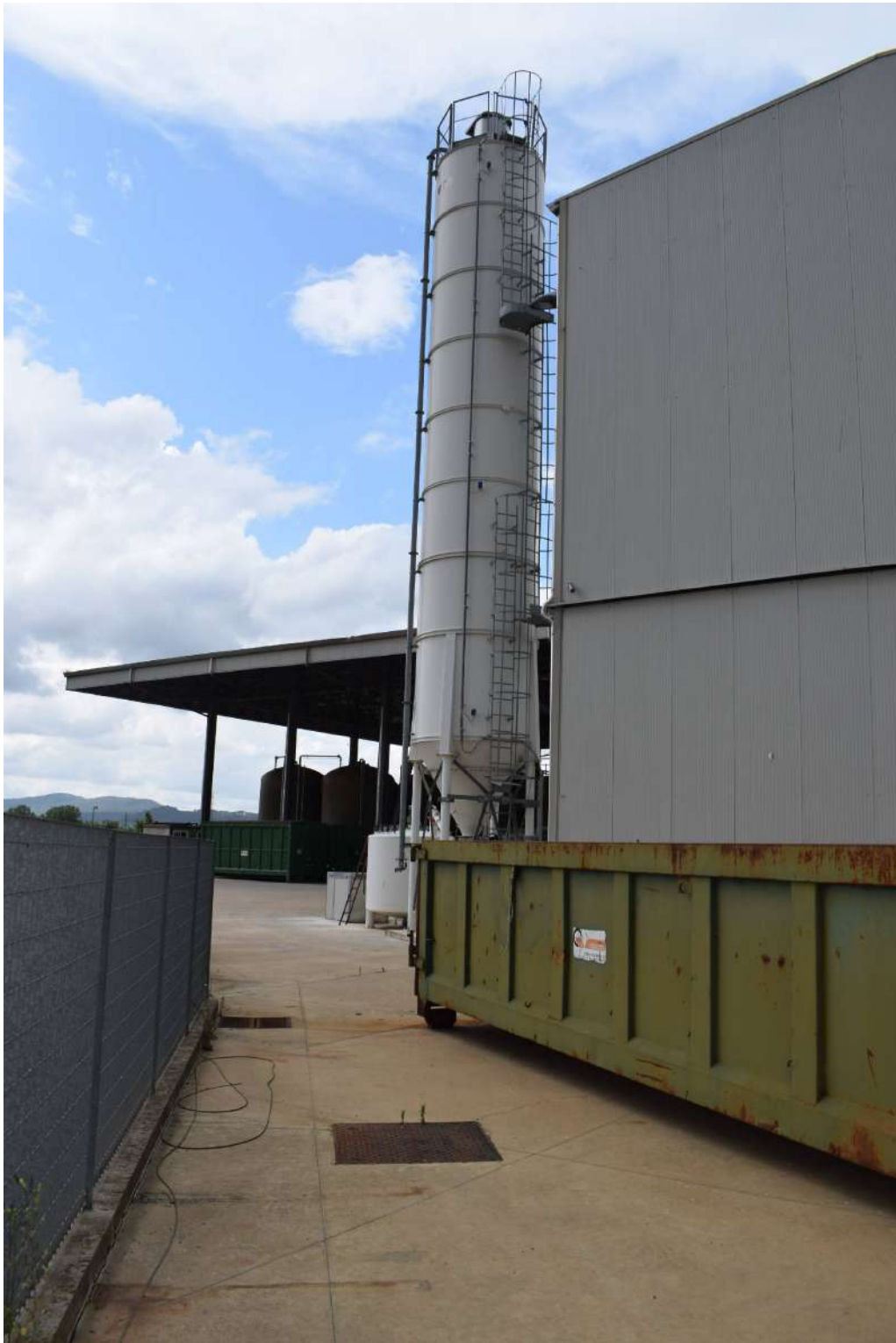
Foto n. 76 _ Sopralluogo 17/06/2020 Silos calce (installato con AIA n. 43/2013) in angolo al capannone 3
