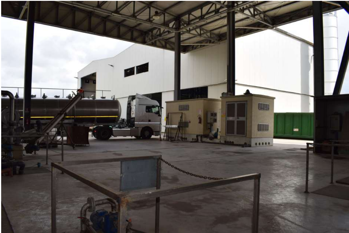
Foto n. 60 _ Sopralluogo 17/06/2020 Le cabine elettriche ed oltre il grande Capannone CP2, CP3, CP4
