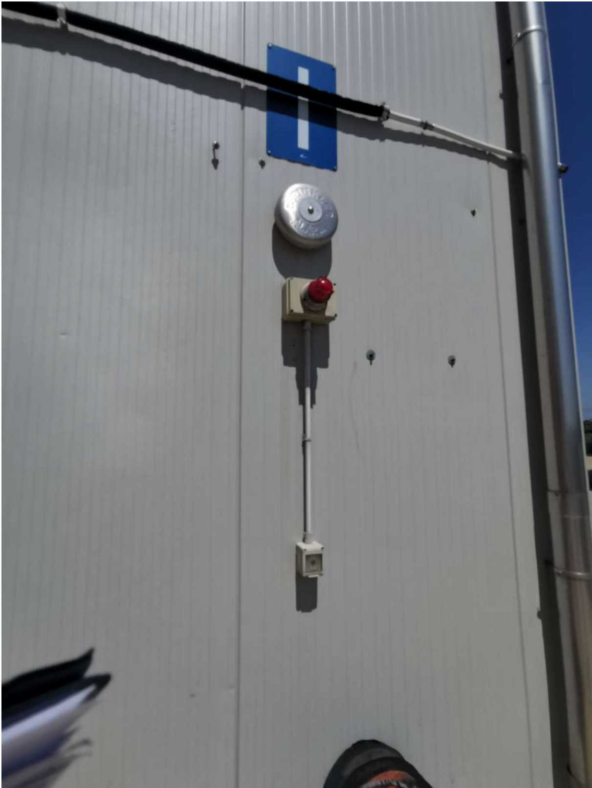
Foto n. 73 _ Sopralluogo 17/06/2020 Allarme antincendio sulle pareti esterne del Capannone CP2, CP3 e CP4
