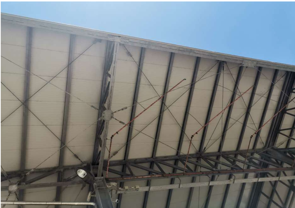
Foto n. 46 _ Sopralluogo 17/06/2020 Sprinkler sotto la copertura del capannone CP1
