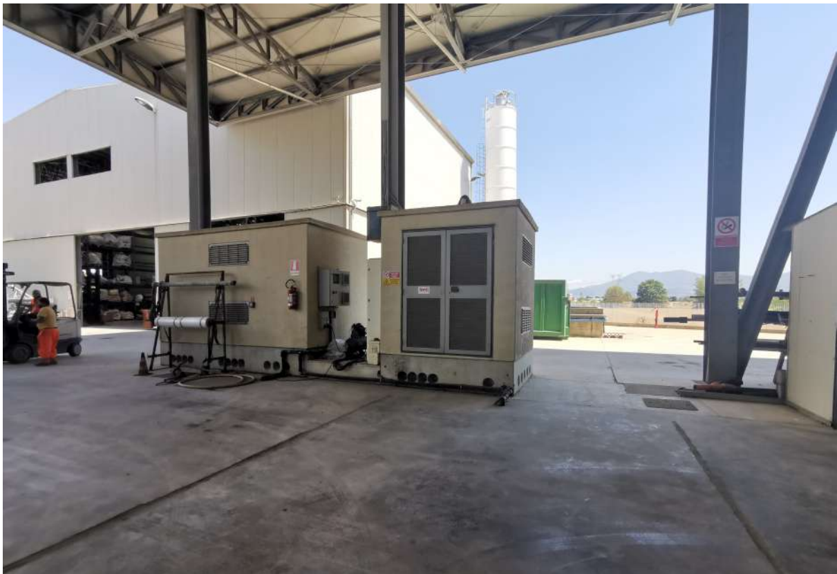
Foto n. 61 _ Sopralluogo 17/06/2020 Le cabine elettriche ed oltre il grande Capannone CP2, CP3, CP4
