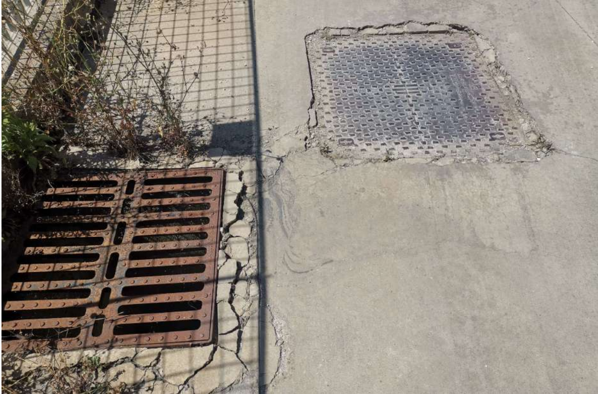
Foto n. 45 _ Sopralluogo 17/06/2020 Particolare dello stato di manutenzione della pavimentazione industriale del piazzale
