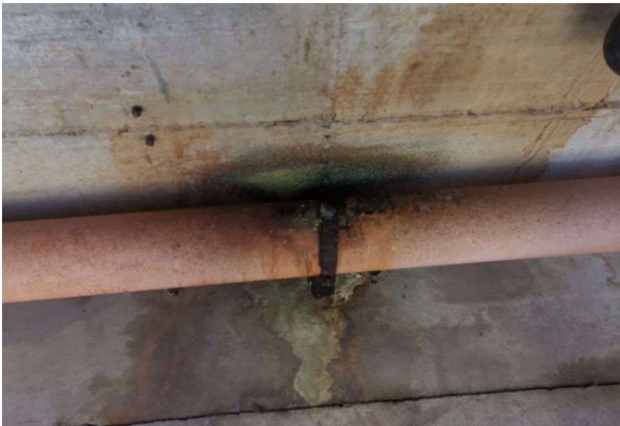
Foto n. 32 _ Sopralluogo 17/06/2020 Capannone CP1 (tettoia): particolare delle condizioni di manutenzione delle tubazioni
