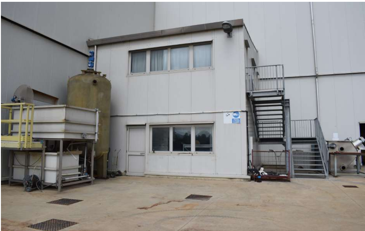
Foto n. 72 _ Sopralluogo 17/06/2020 Fabbricato mensa e servizi addossato al Capannone 3 (lato tergaie), su due livelli con scala esterna in acciaio
