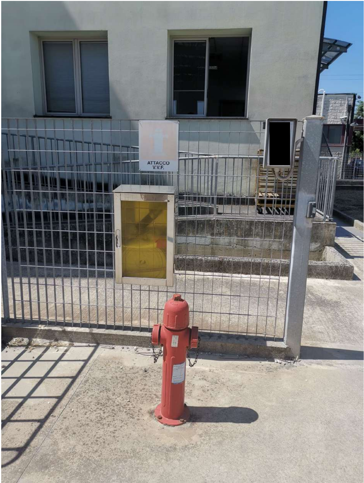
Foto n. 5 _ Sopralluogo 17/06/2020 Idrante soprassuolo e naspo fronte ingresso palazzina uffici
