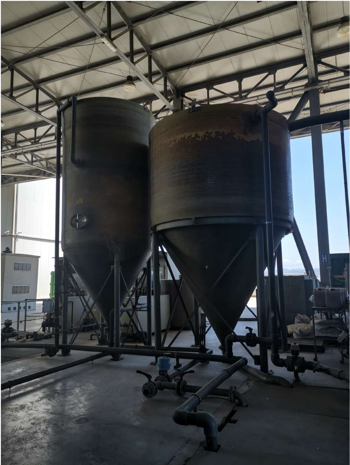
Foto n. 48 _ Sopralluogo 17/06/2020 Capannone CP1: Silos sedimentazione (ora disattivati) in funzione del biologico
