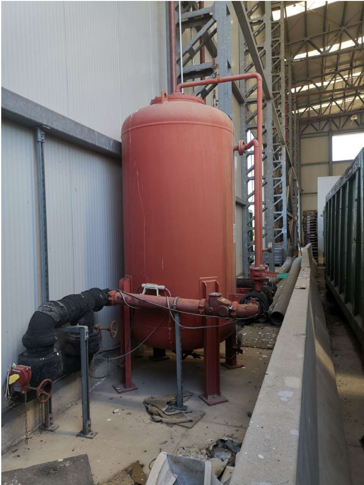
Foto n. 68 _ Sopralluogo 17/06/2020 Capannone CP2, serbatoi impianto antincendio
