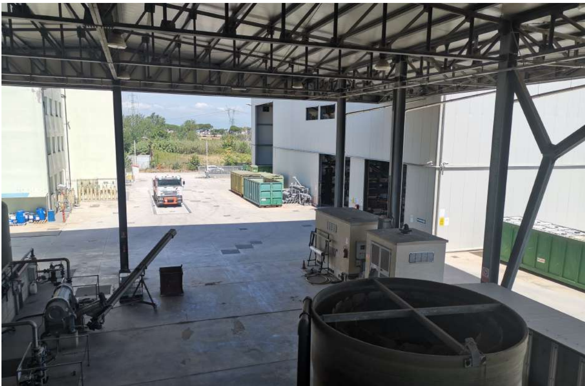
Foto n. 50 _ Sopralluogo 17/06/2020 Capannone CP1: dalla passerella sopraelevata vista sull'impianto e sull'area
