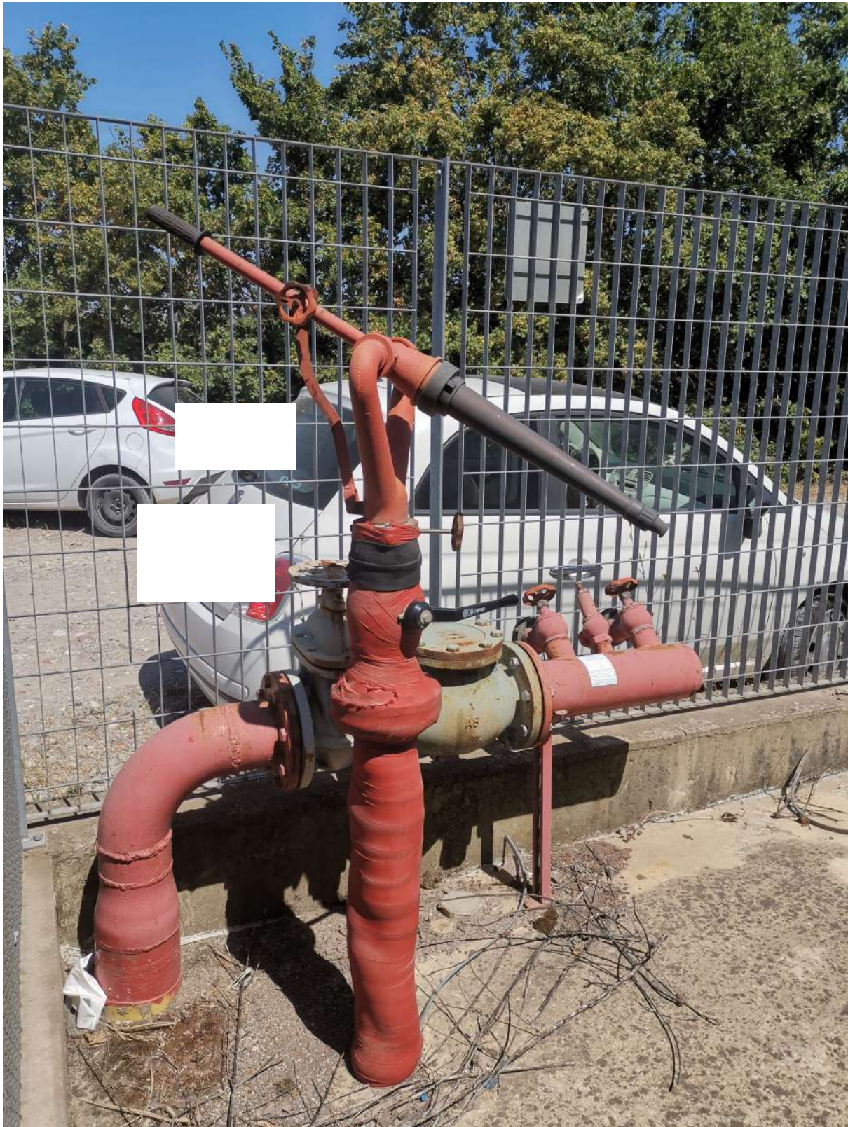
Foto n. 75 _ Sopralluogo 17/06/2020 Spingarde antincendio orientabili su tutto il perimetro del piazzale
