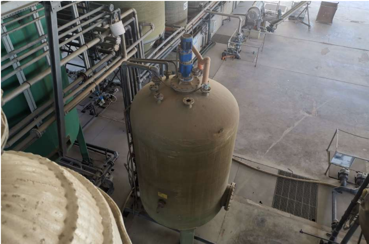
Foto n. 51 _ Sopralluogo 17/06/2020 Capannone CP1: dalla passerella sopraelevata vista sull'impianto
