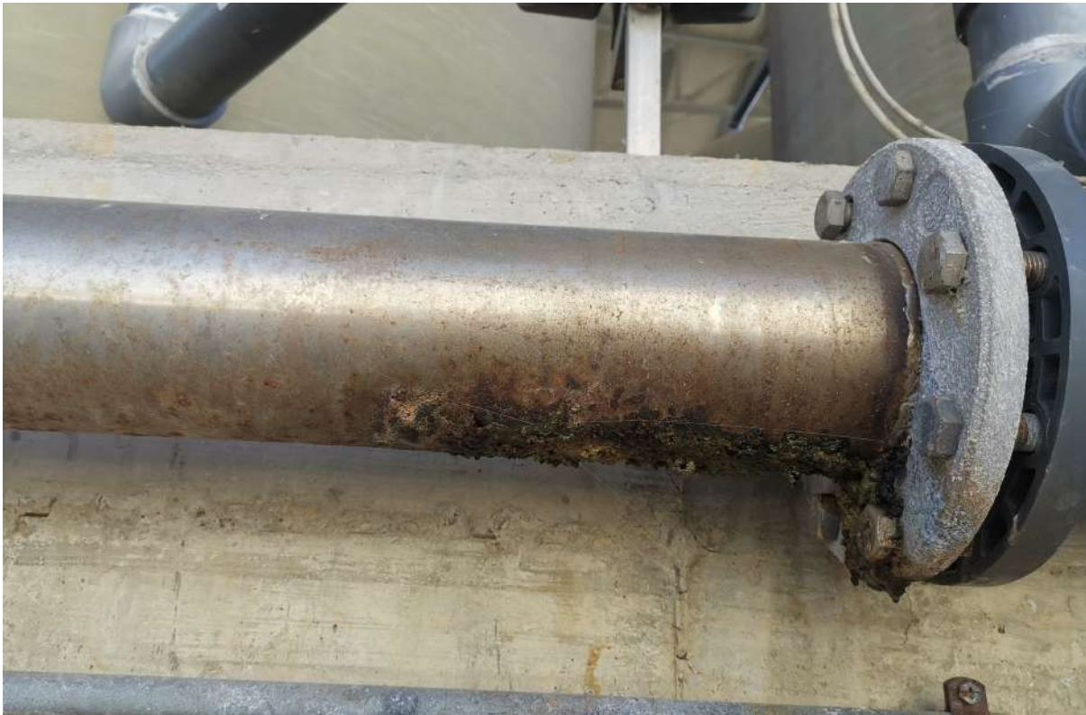
Foto n. 35 _ Sopralluogo 17/06/2020 Capannone CP1: tubazioni dei silos con ruggine e corrosione
