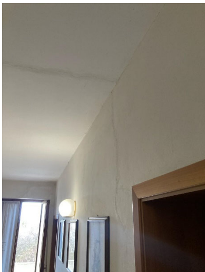
Crepe sul muro portante piano primo
