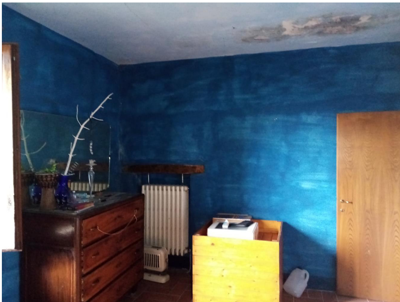
FOTO 17– camera - dettaglio infiltrazioni
