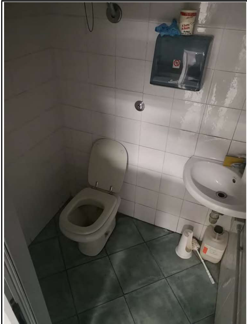
Foto n. 33 Interno capannone principale: servizi
