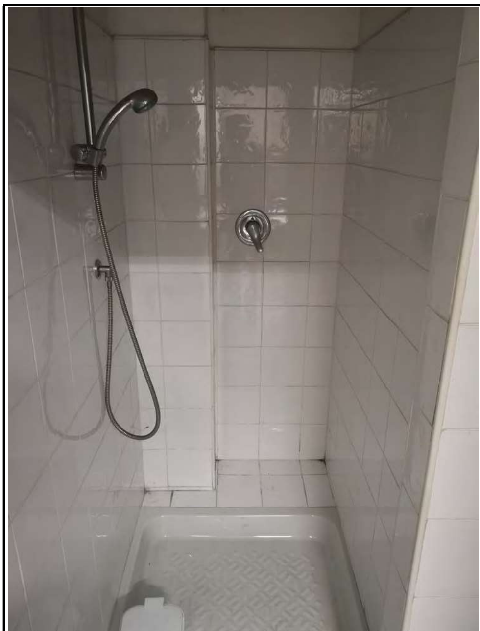
Foto n. 34 Interno capannone principale: servizi
