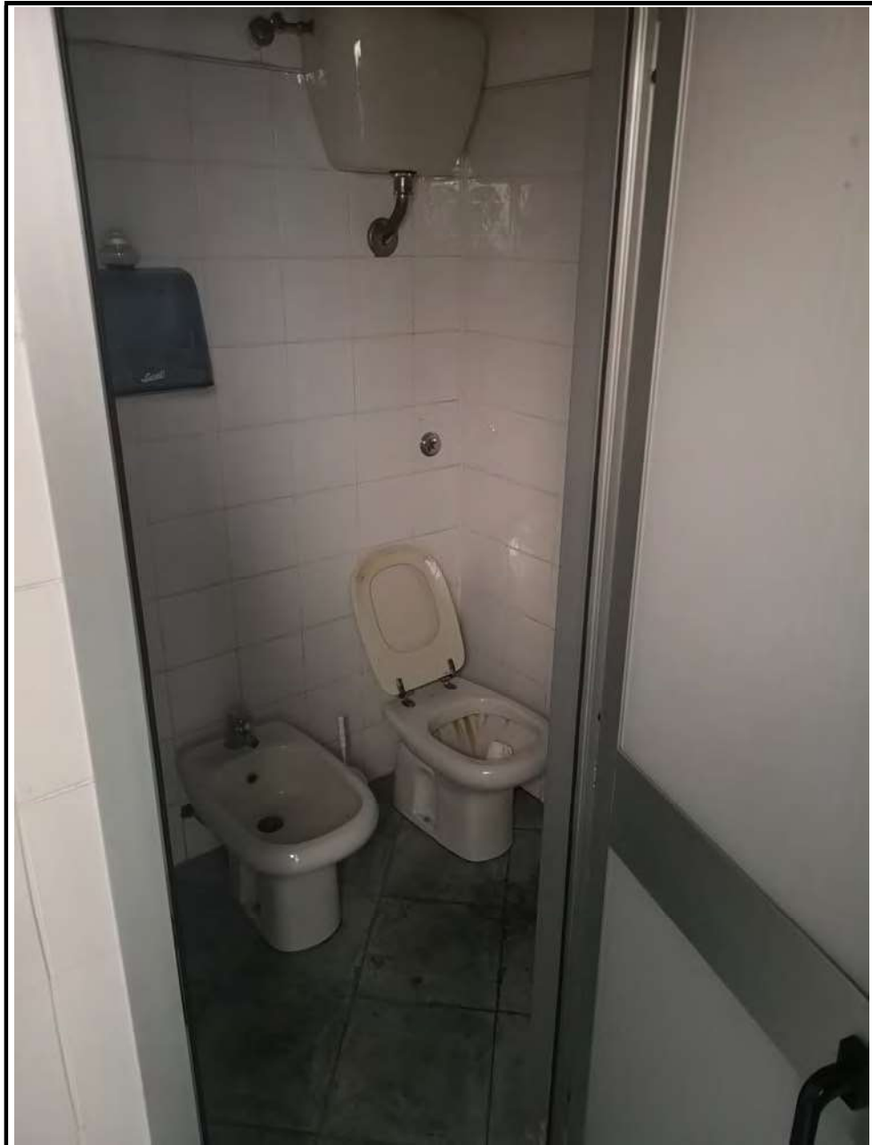
Foto n. 35 Interno capannone principale: servizi
