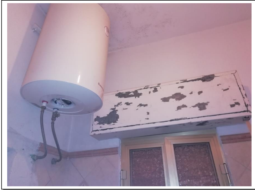
09. Interno servizio igienico dell'unità immobiliare al piano primo con vista lato sud-est, in foto finestra sul lato del cortile retrostante comune. Particolare impianto di riscaldamento acqua tramite boiler.
