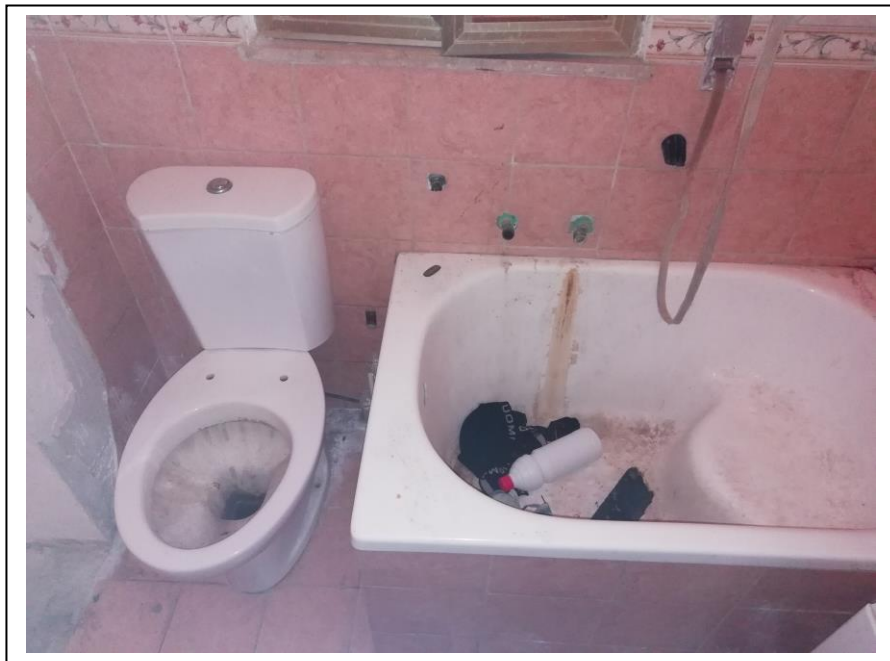
08. Interno dell'unità immobiliare con vista servizio igienico piano primo. Esposizione lato sud-est, particolare su impianto sanitario in pessime condizioni d'uso e rubinetteria incompleta.
