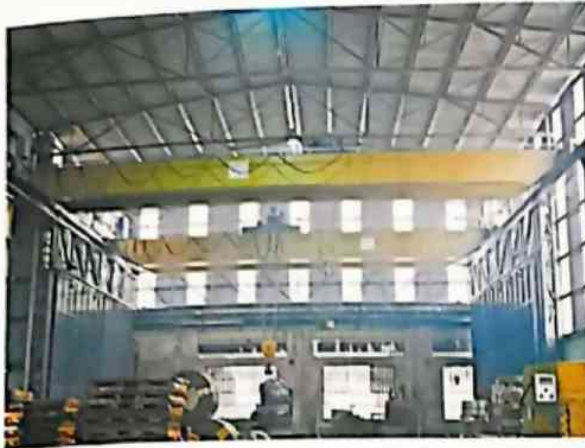
N° 2 GRU BITRAVI - PORTATA TON. 10 e TON. 25
