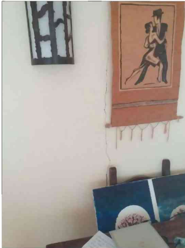
Particolare fessurazione su parete
