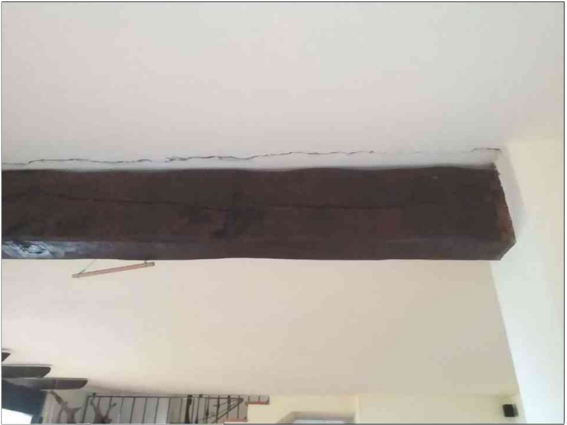
Fessurazioni lungo il soffitto
