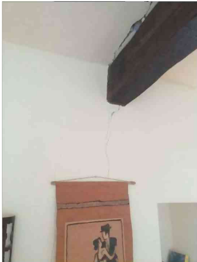
Fessurazioni soffitto e parete
