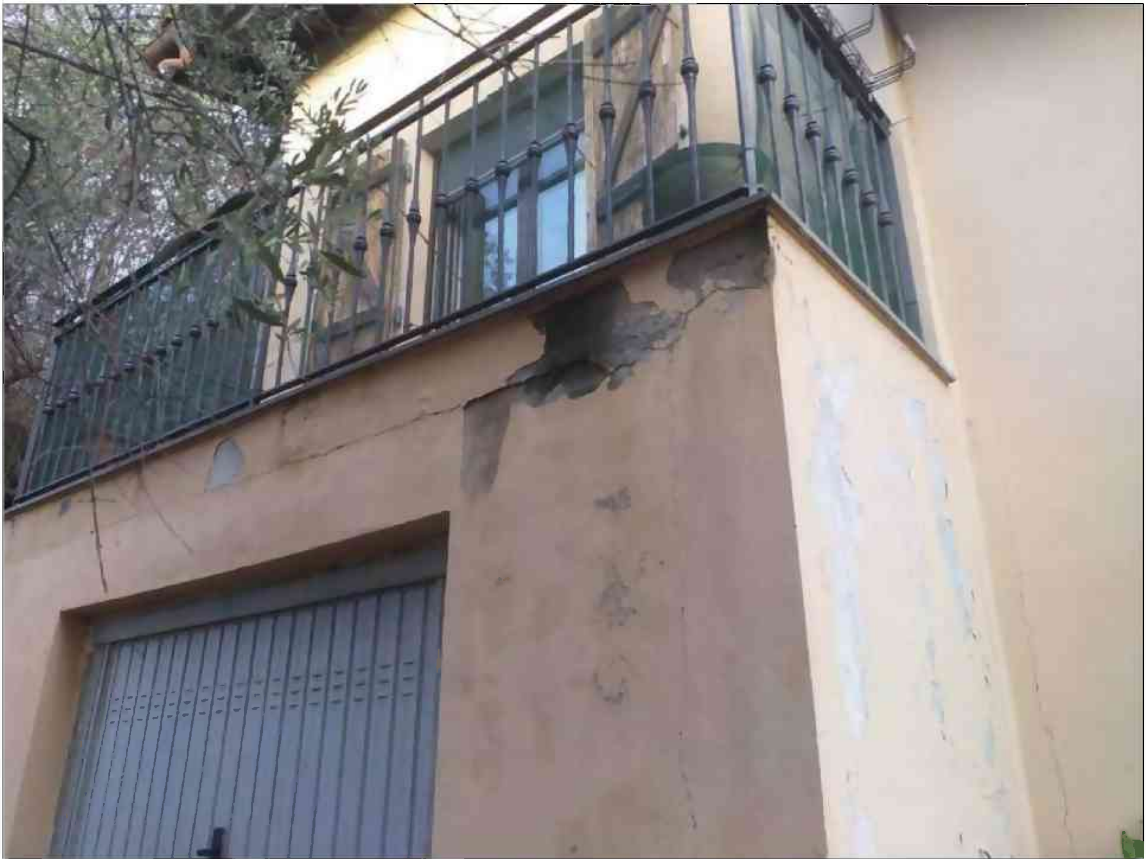
Ammaloramento in corrispondenza del terrazzo
