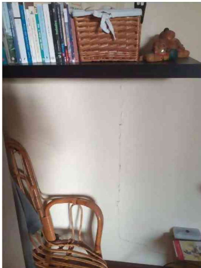
Fessurazione lungo la parete
