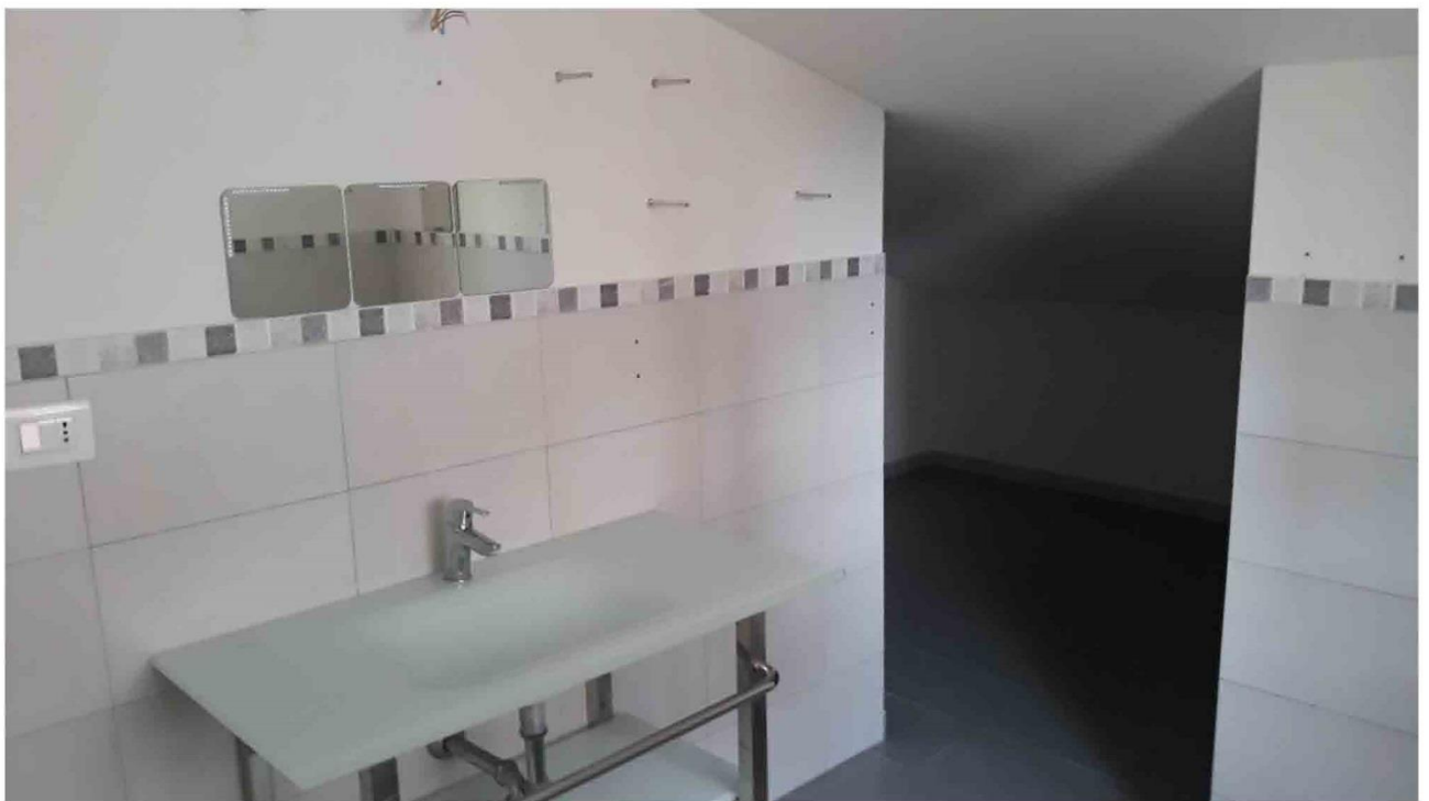
Lott n.1 - Foto n.27 – deposito occasionale/bagno
