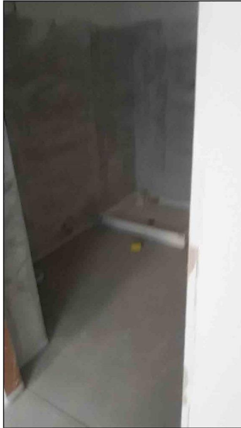
Lott n.3 - Foto n.29 – deposito occasionale – bagno
