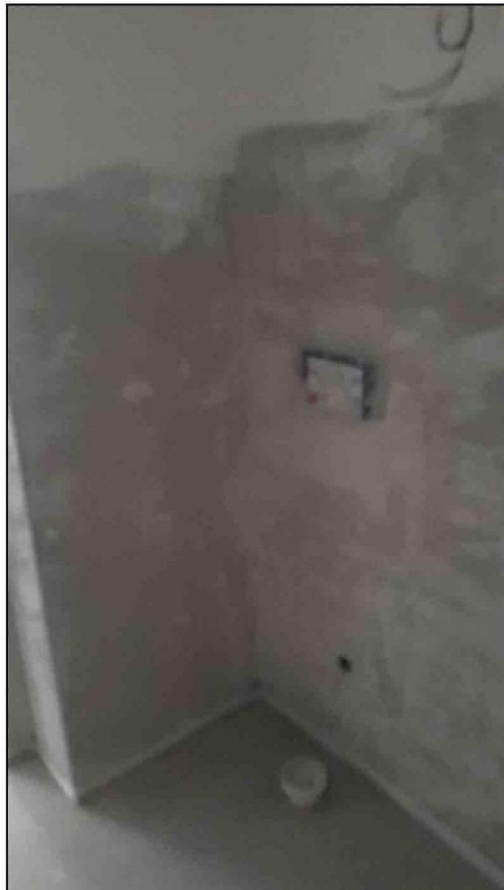
Lott n.3 - Foto n.30 – deposito occasionale - bagno
