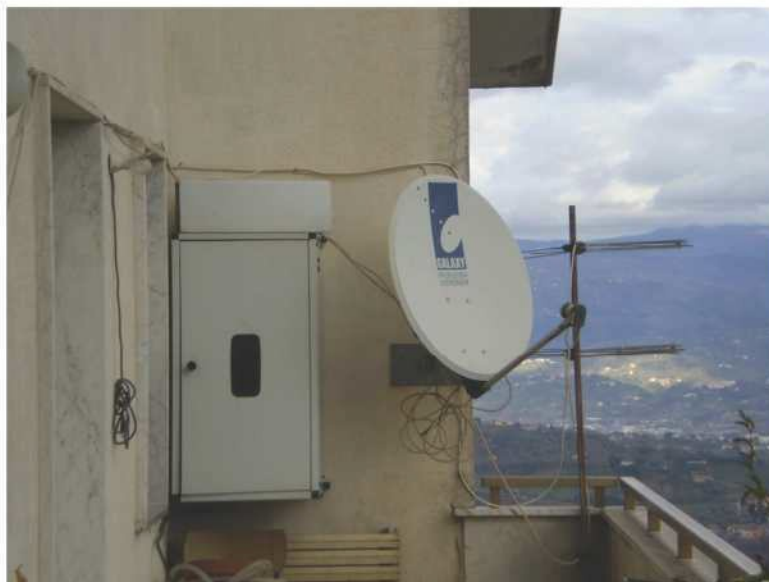
Foto n. 12 – Caldaia esterna (non funzionante) su balcone laterale
