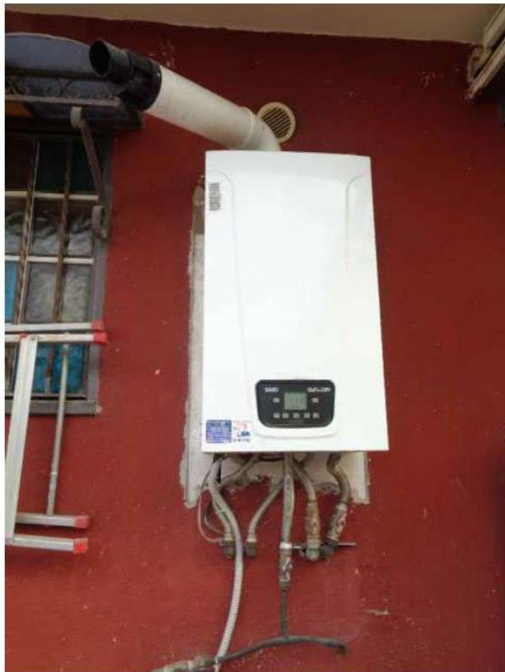
Foto n. 34: • Caldaia impianto autonomo.
