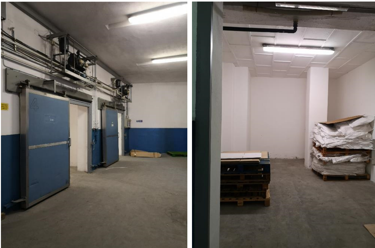
Foto 5: ingresso celle frigorifere
