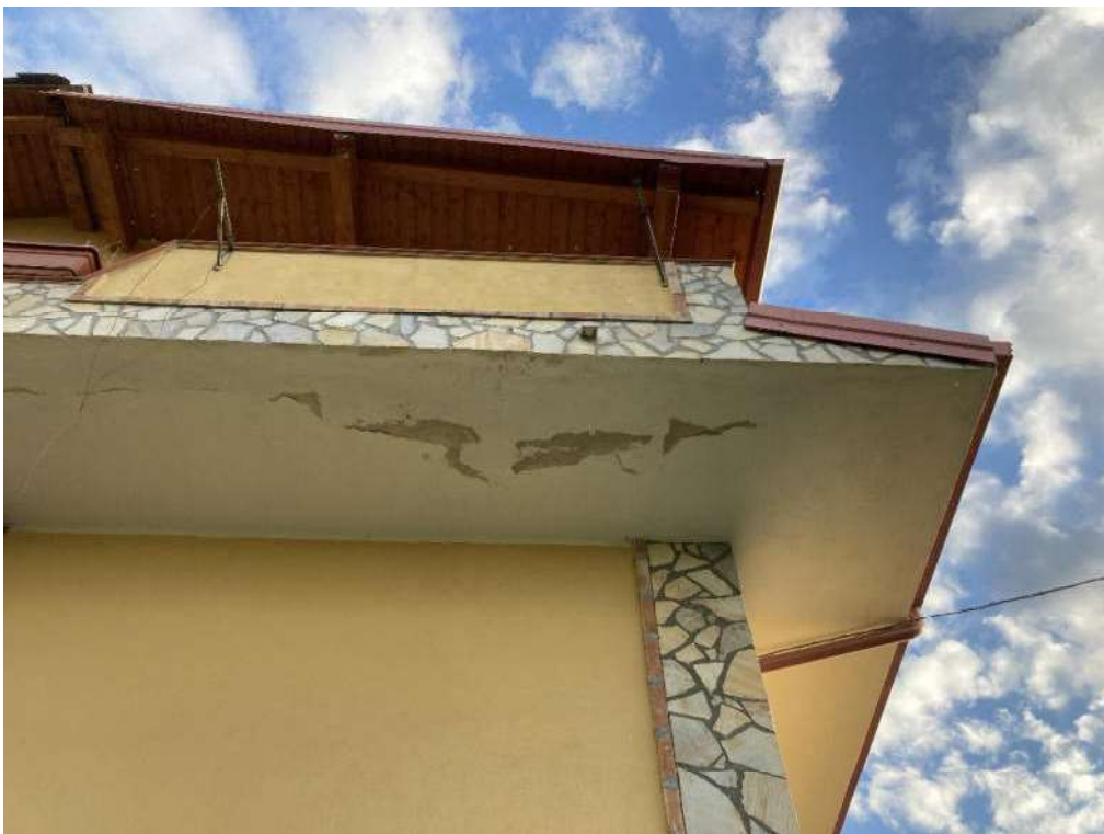
Foto 7 – Particolare degrado terrazzo primo piano
