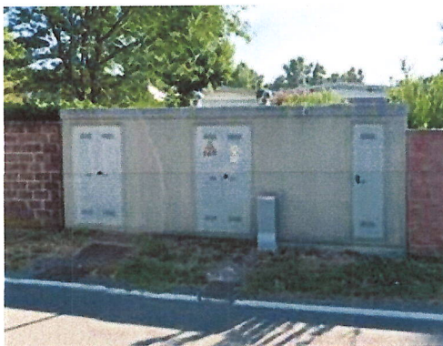
Vista cabina da via Sele - Fronte ovest
