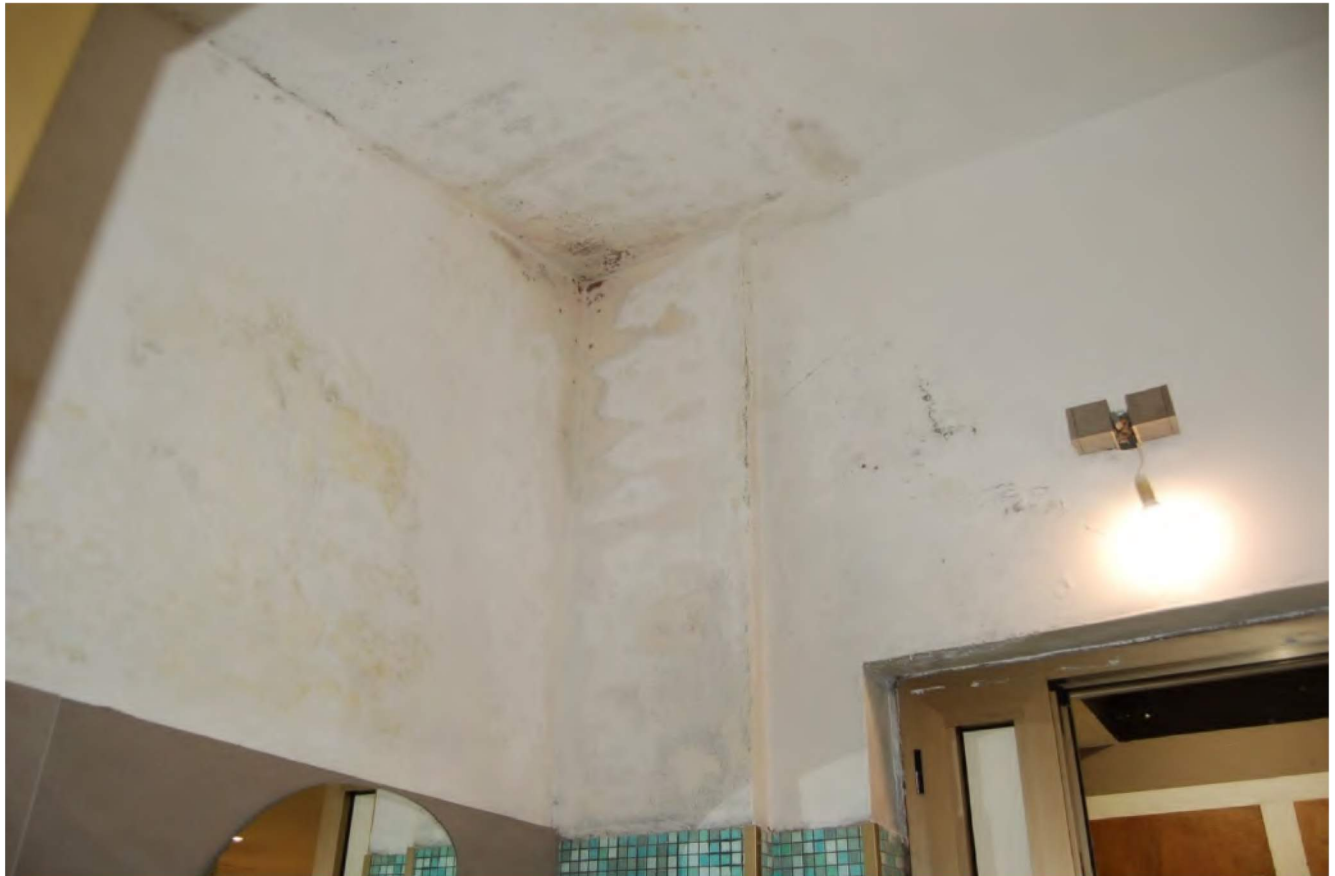
Foto 66 – Dettaglio dello stato di degrado del bagno
