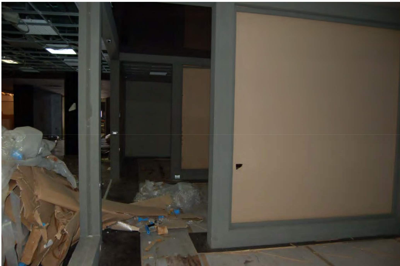
Foto 116 - Vista di dettaglio dello stato di degrado
