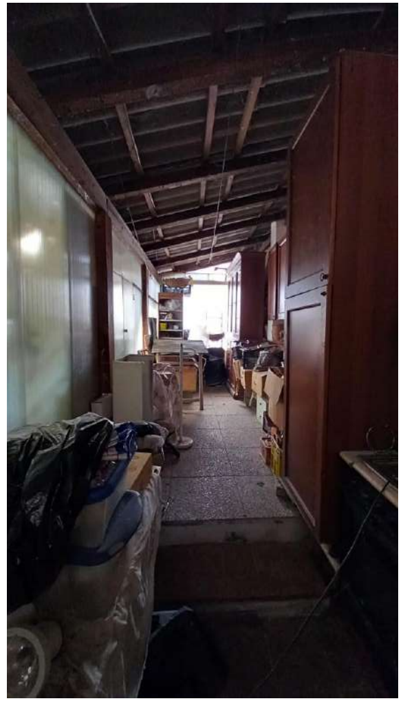
Foto 13 -- Vista delle tettoie/verande sul mappale 3629
