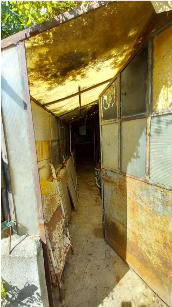
Foto 12 -- Vista delle tettoie/verande sul mappale 3629
