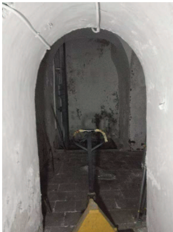
Foto n. 55 – Bene n. 4 - montacarichi di collegamento con il Bene n. 1 sub 59
