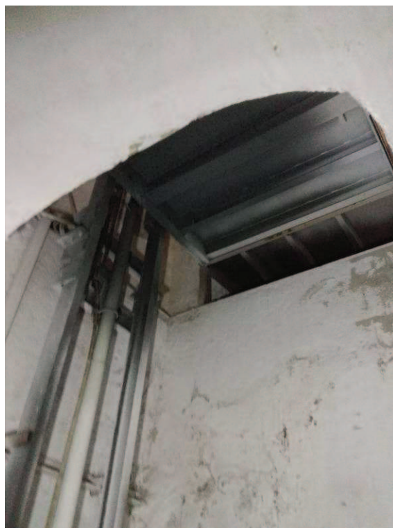
Foto n. 59 – Bene n. 4 - montacarichi di collegamento con il Bene n. 1 sub 59
