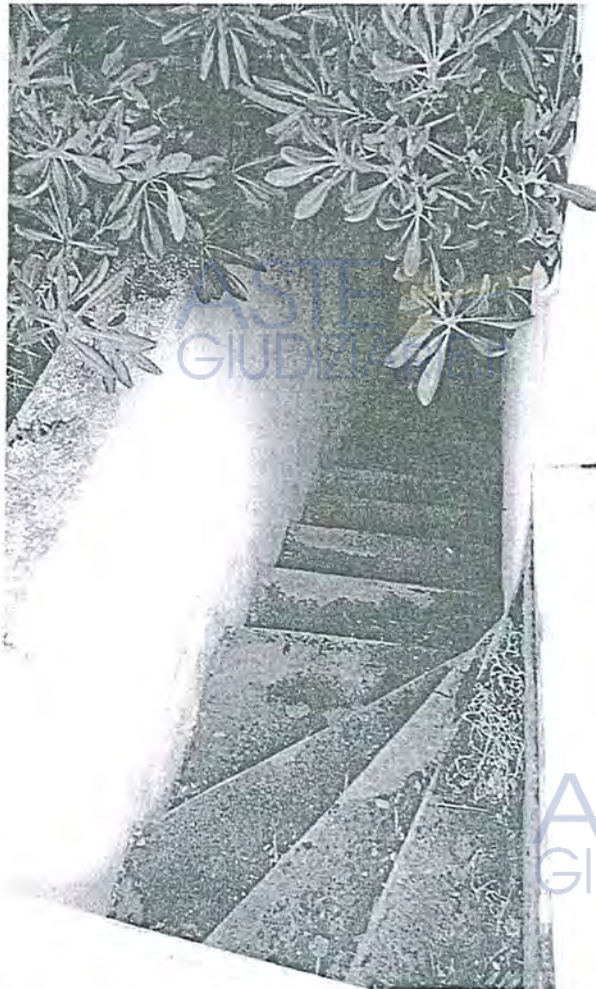
Foto 41 – scale accesso al seminterrato del sub. 13
