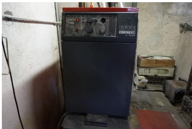
Piano interrato – Caldaia autonoma su C.T. comune
