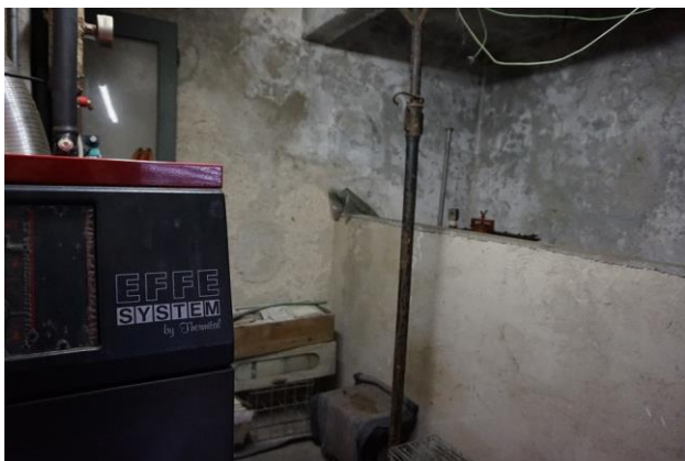
Piano interrato – Caldaia autonoma su C.T. comune
