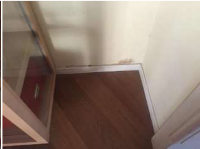
- Particolari infiltrazioni soggiorno
