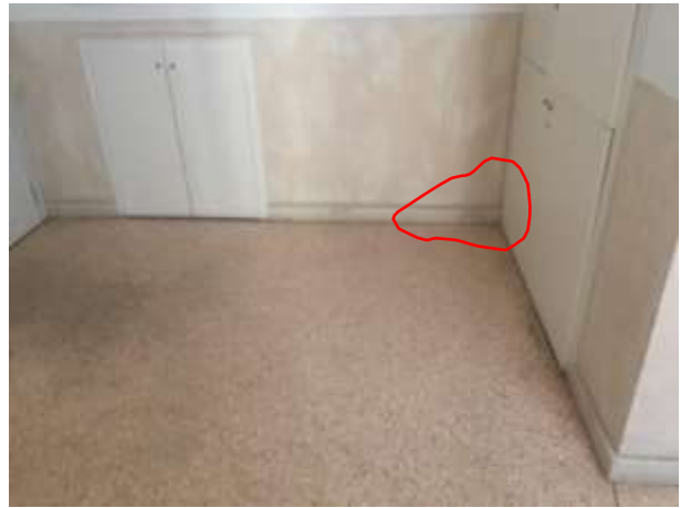
- Particolare umidità zona contatori comune
