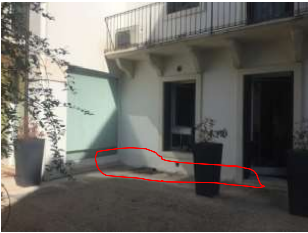
- Particolare umidità muro esterno
