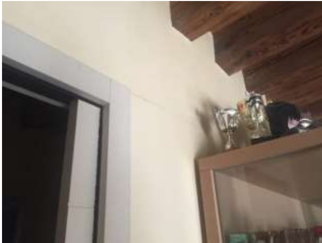
- Particolare crepo soggiorno
