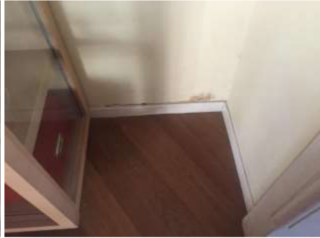
Particolare infiltrazioni soggiorno
