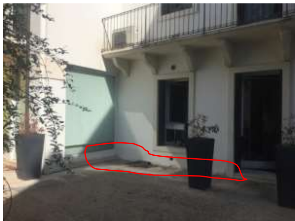
- Particolare umidità muro esterno
