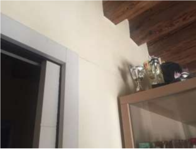
- Particolare crepo soggiorno
