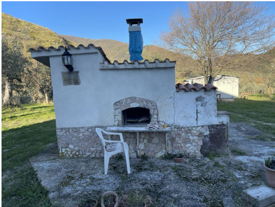
Fotografia n.11 – Corte esterna – Il manufatto “Forno-deposito bombola Gpl” ricompreso all’interno della corte esterna di pertinenza del fabbricato censito al Foglio n.6, Particella n.107.
